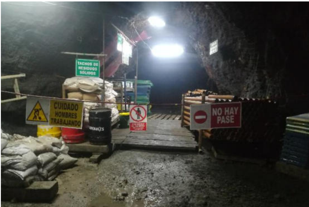
Figura 60 — Cámara de aditivos, tuberías de perforación y accesorios de perforación
