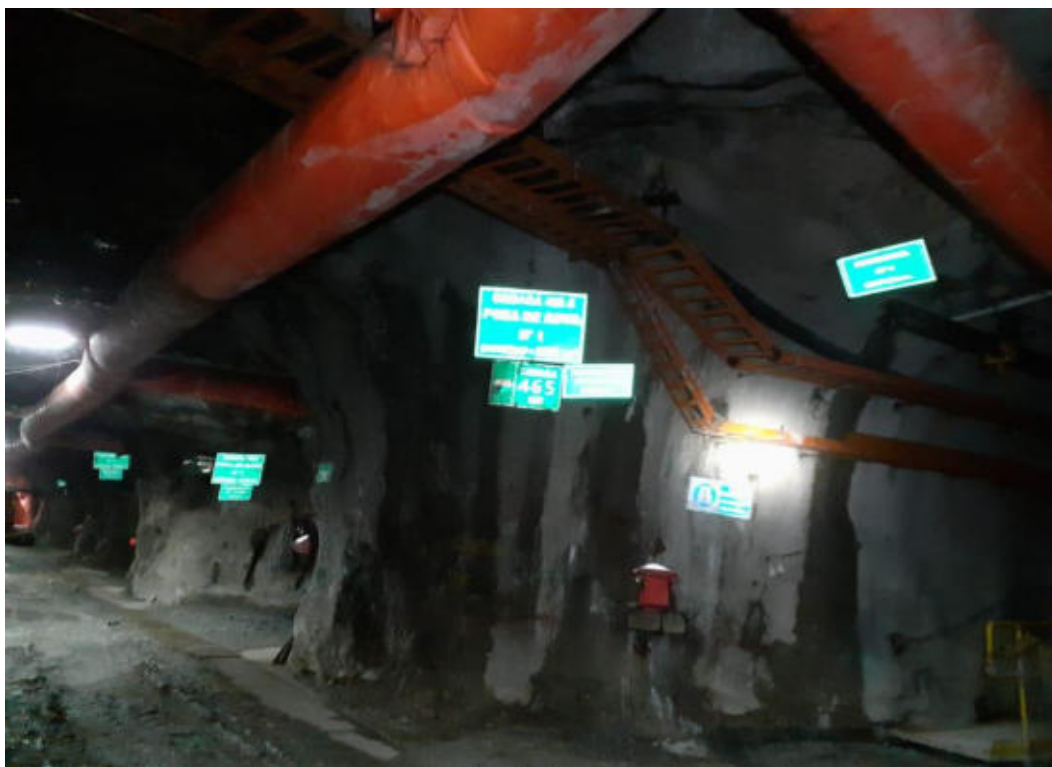
Figura 59 — Infraestructuras en interior mina, cámaras de bombeo, subestaciones eléctricas
