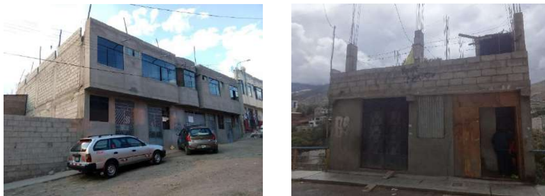
Figura 17 — Elementos no estructurales sin conexión de parapetos
