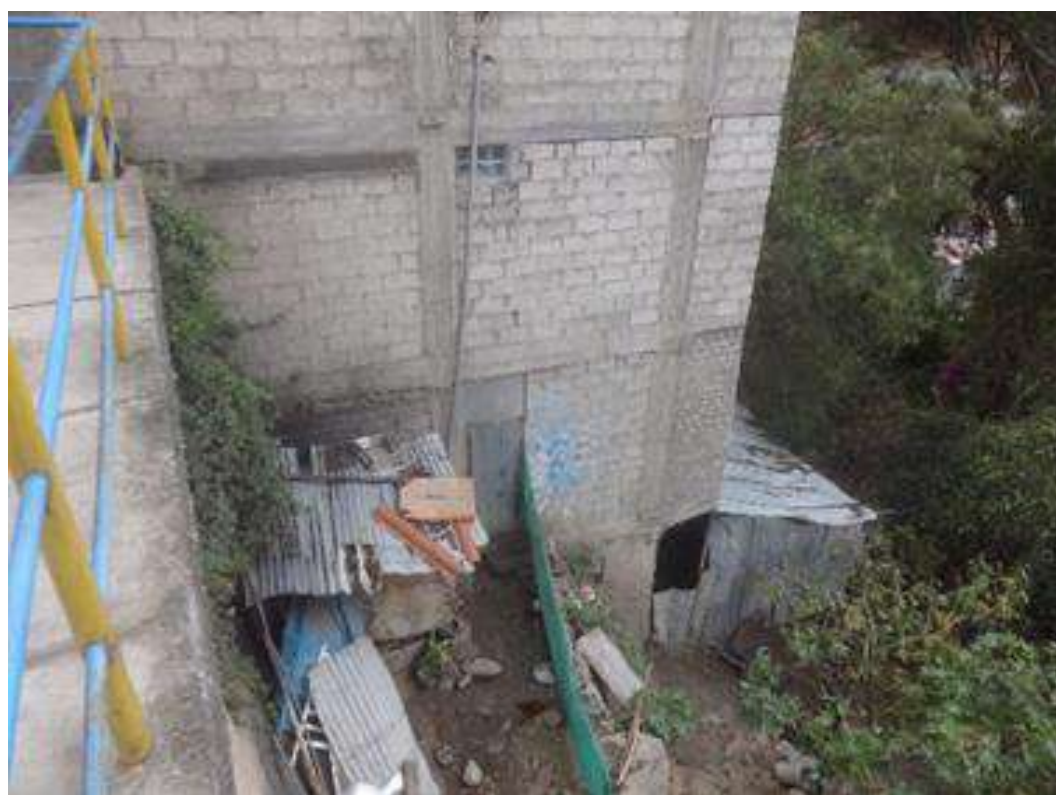
Figura 43 — Vivienda ubicada en talud con riesgo a sufrir un desplazamiento lateral
