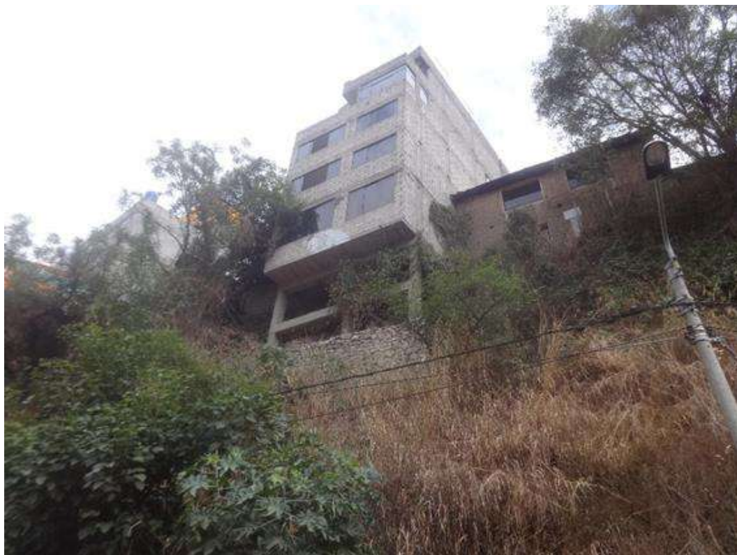
Figura 48 — Vivienda ubicada en talud con pendiente mayor al 50%
