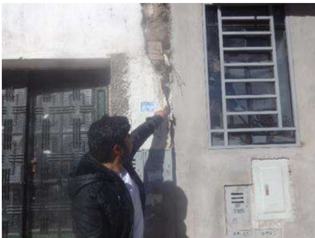
Figura 45 — Viviendas colindantes sin junta sísmica
