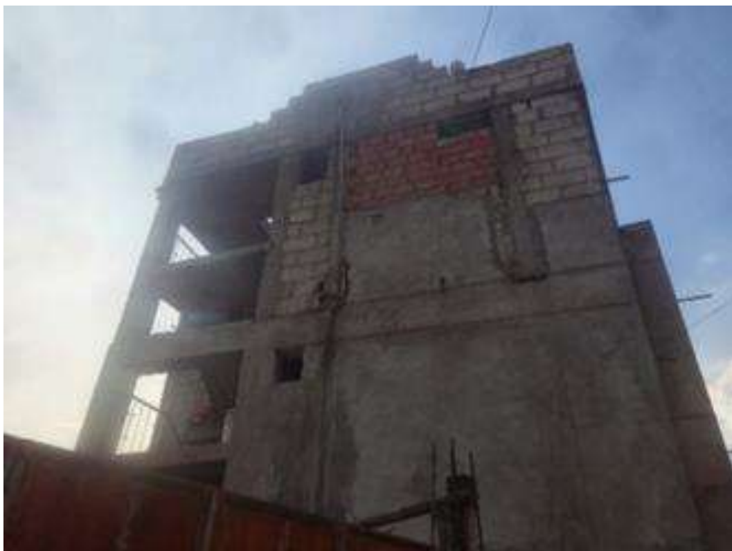
Figura 47 — Albañilería de baja calidad y no homogénea
