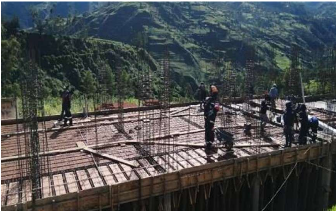
Figura 62 — Personal obrero realizando el colocado y amarre de acero en losa aligerada del bloque IV según especificaciones técnicas
