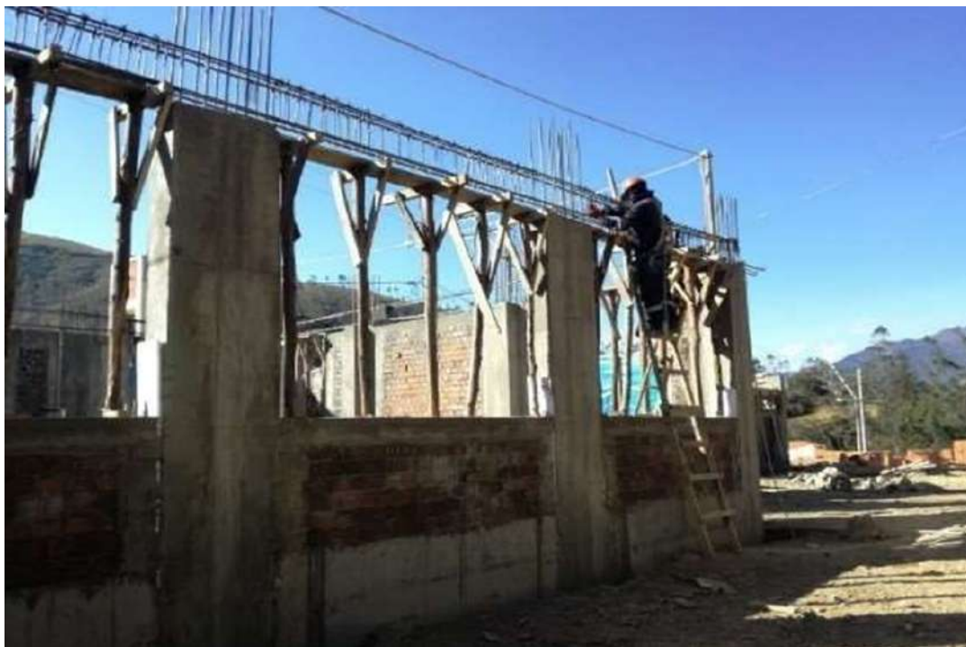
Figura 54 — Personal obrero ejecutando el colocado y amarre de acero en vigas del bloque I
