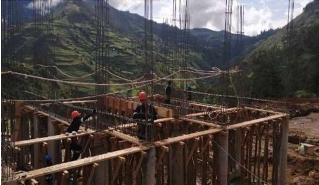
Figura 59 — Personal obrero realizando el colocado y amarre de acero en vigas del bloque IV según especificaciones técnica
