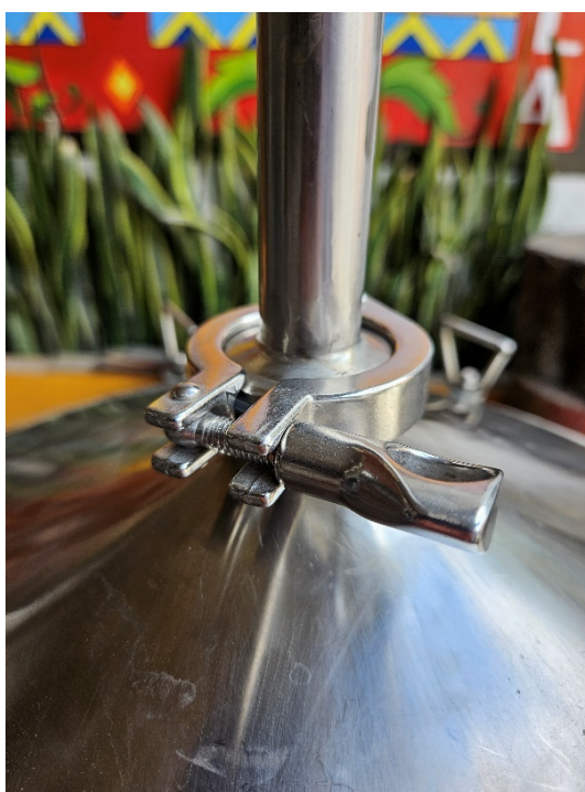
Fotografía 08 — Tubería de paso con abrazadera tipo Clamp
