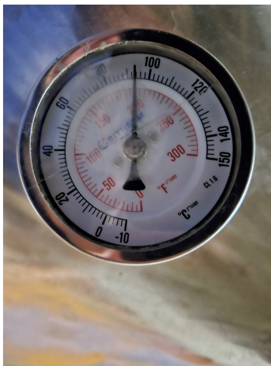
Fotografía 05 — Indicador de temperatura alcanzada en el proceso de extracción, tratamiento arrastre de vapor.
