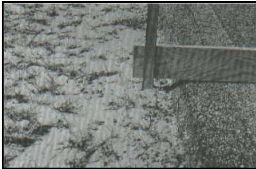
Figura 18 — Nivel de Severidad Bajo de Desnivel en la Berma.
