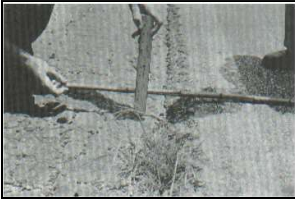
Figura 19 – Nivel de Severidad Media de Desnivel en la Berma.
