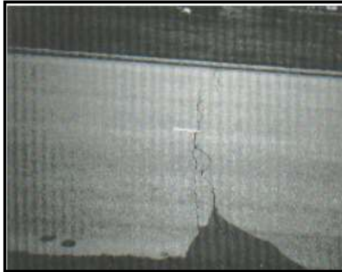
Figura 24 – Nivel de Severidad Medio de Grietas Longitudinales y Transversales en el Pavimento.
