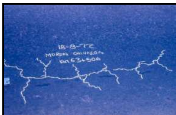
Figura 2 – Nivel de gravedad Bajo de piel de cocodrilo.
