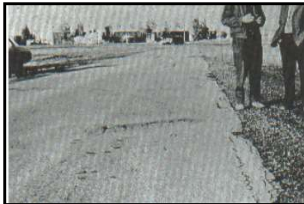
Figura 11 — Nivel de Severidad Medio de Abultamiento y Hundimiento en el Pavimento.
