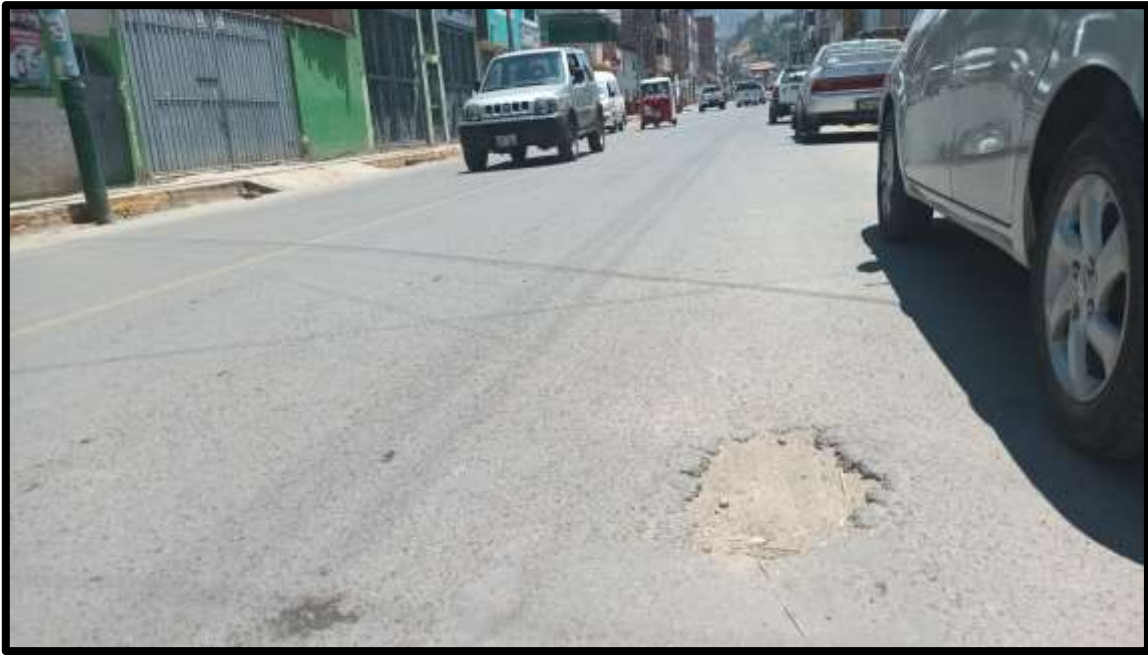
Figura 98 — Huevo de Baja severidad / Tramo 12 / AV. PERU KM 1+947 AL KM 1+982.40
