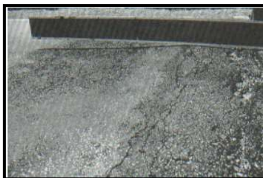
Figura 12 – Nivel de Severidad Alto de Abultamiento y Hundimiento en el Pavimento.
