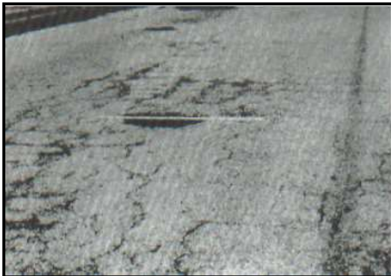
Figura 29 — Nivel de Severidad Medio de Huecos en el Pavimento.
