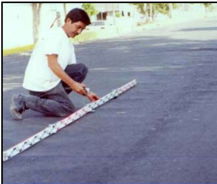
Figura 13 – Corrugaciones en el pavimento.
