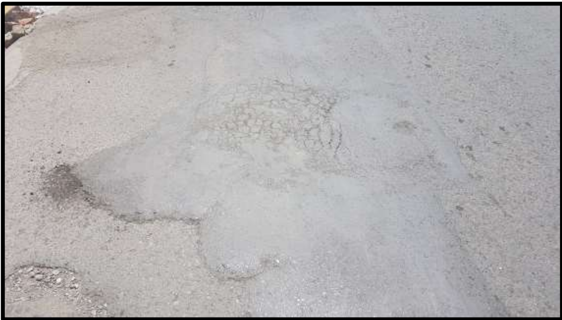
Figura 97 — Hinchamiento de severidad Media / Tramo 12 / AV. PERU KM 1+947 AL KM 1+982.40
