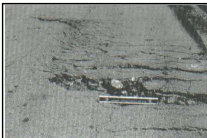
Figura 34 – Grietas Parabólicas en el Pavimento.
