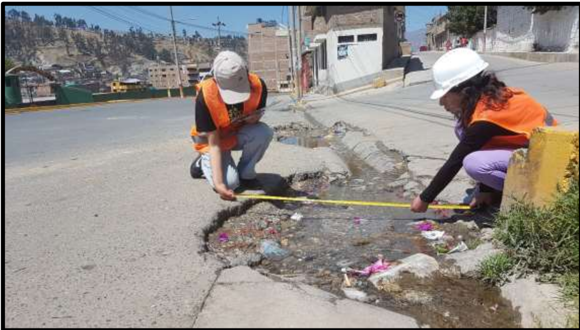
Figura 95 — Huevo en borde de severidad media / Tramo 06 / AV. LEONCIO PRADO KM 0+708 AL KM 0+743.40
