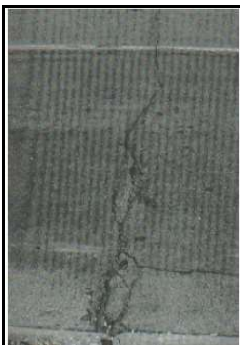
Figura 21 – Grietas de Reflexión.
