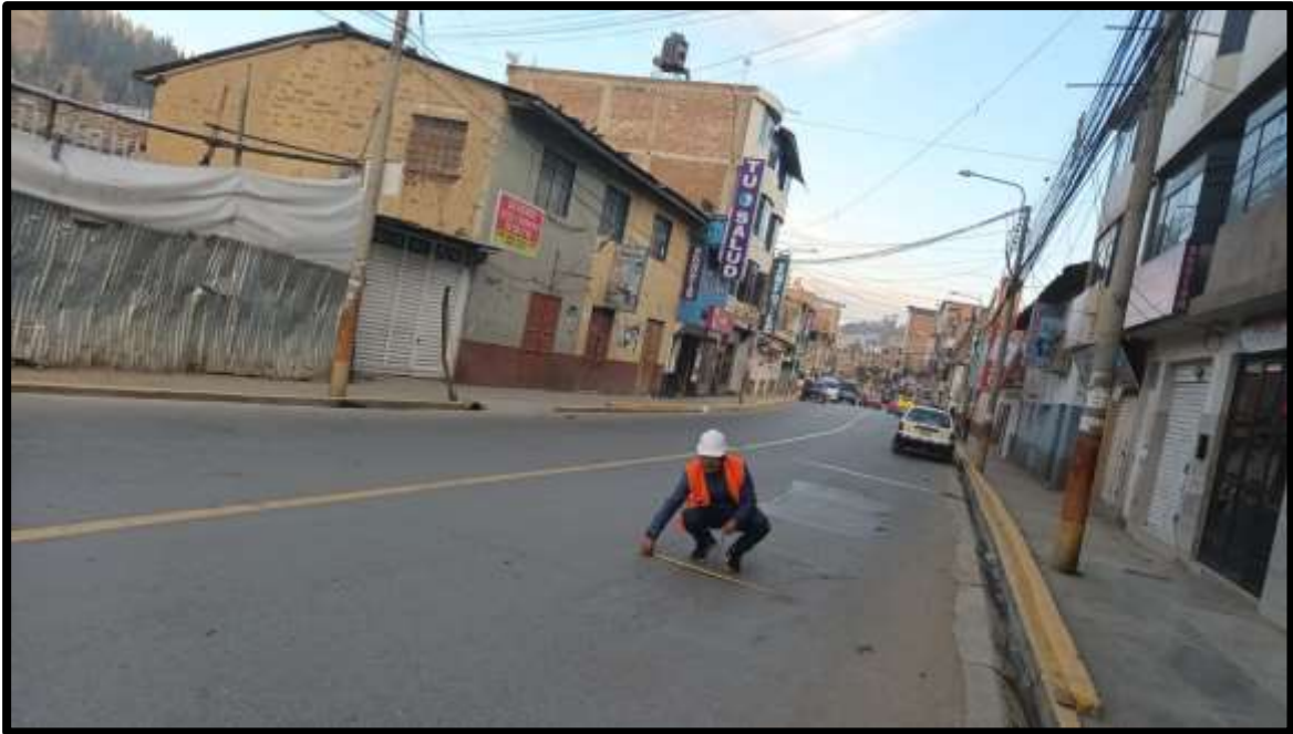
Figura 96 — Parcheo de severidad Media en la AV. PERU, KM 1+593 AL KM 1+628
