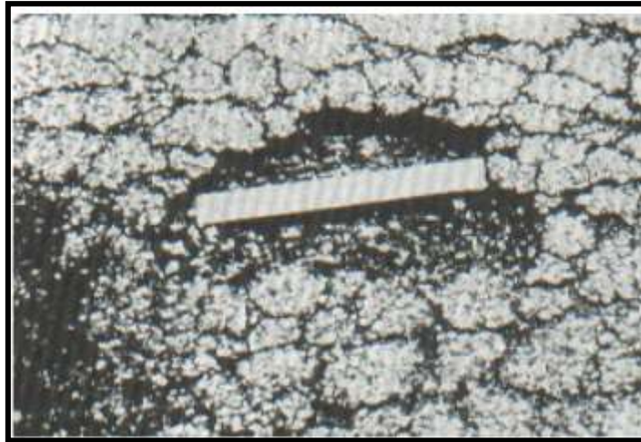
Figura 28 — Nivel de Severidad Bajo de Huecos en el Pavimento.
