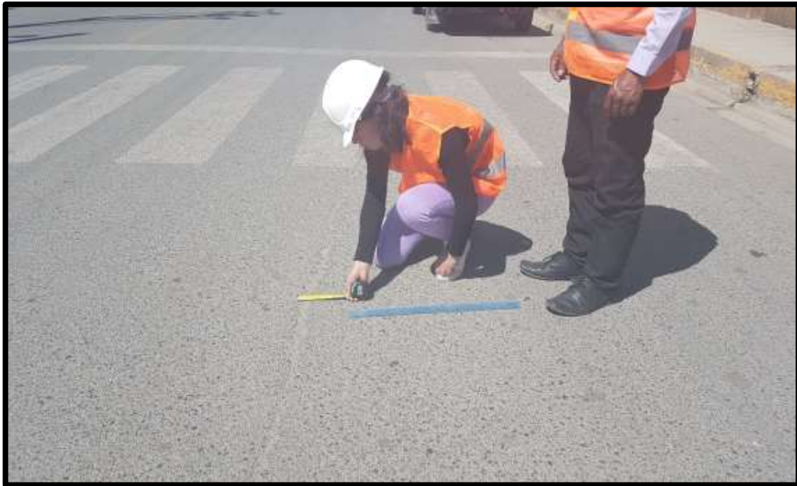
Figura 92 — Grietas Longitudinales (ancho > 1 mm y \leq 3 mm). AV. LEONCIO PRADO KM 0+000 AL KM 0+0035.40
