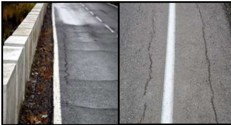
Figura 17 – Grietas de Borde en el pavimento.
