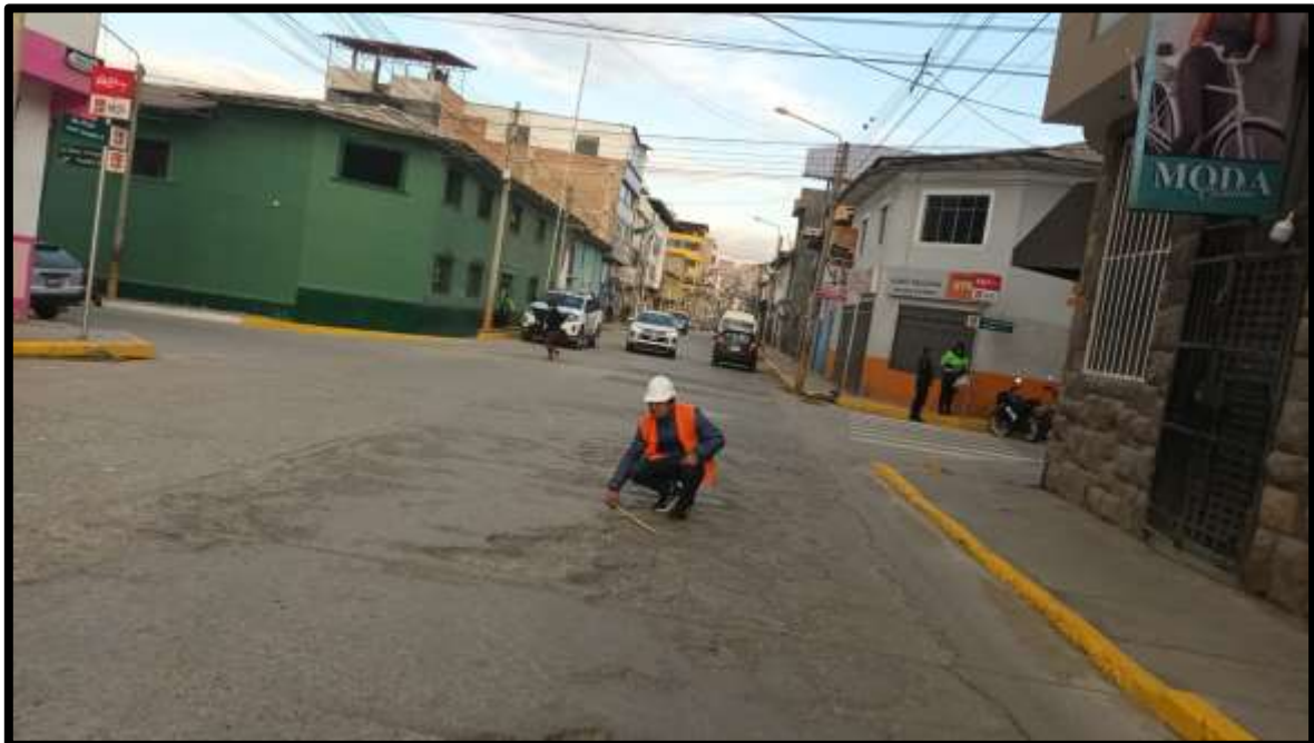
Figura 99 — Agrietamiento en bloque de severidad media / Tramo 13 / AV. PERU KM 2+124 AL KM 2+159.40
