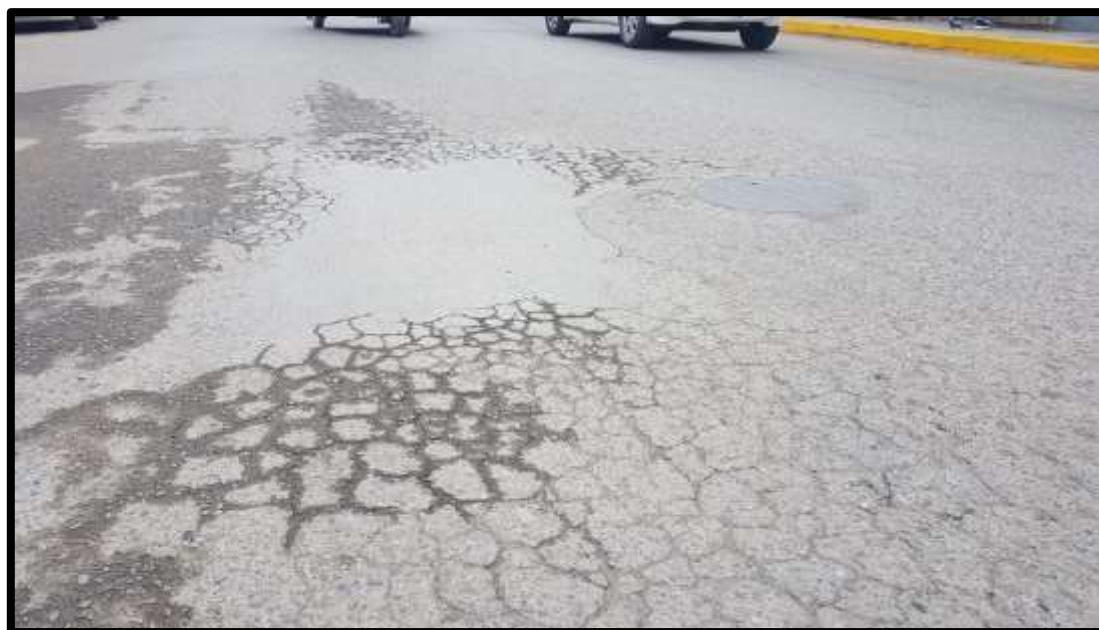
Figura 100 — Piel de cocodrilo de severidad media / Tramo 13 / AV. PERU KM 2+124 AL KM 2+159.40
