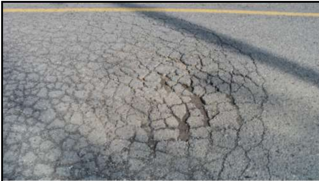
Figura 1 — Presencia de falla piel de cocodrilo.
