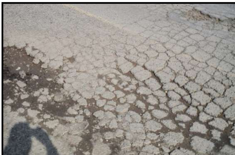
Figura 4 — Nivel de gravedad Alto de piel de cocodrilo.
