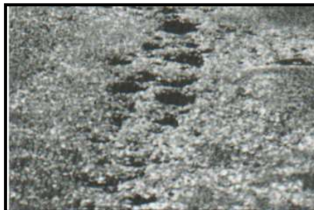
Figura 38 — Nivel de Severidad Alto de Meteorización en el Pavimento.
