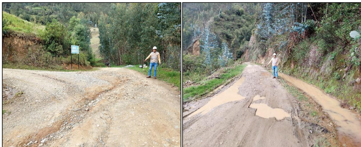
Figura 125 — Situación actual de la carretera en el km 3+600 y km 4+000
