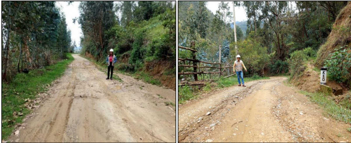
Figura 124 — Situación actual de la carretera en el km 3+300 y km 0+800
