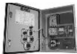
Figura 32: Tablero de encendido del winche eléctrico.
