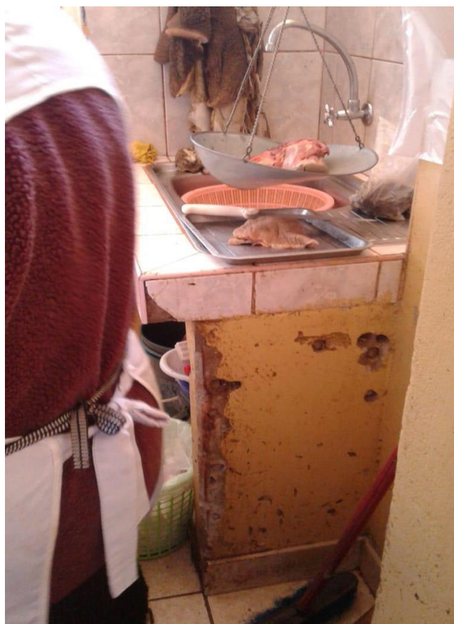
Figura 8. Deterioro del lavadero en un puesto de venta del mercado Progreso.
