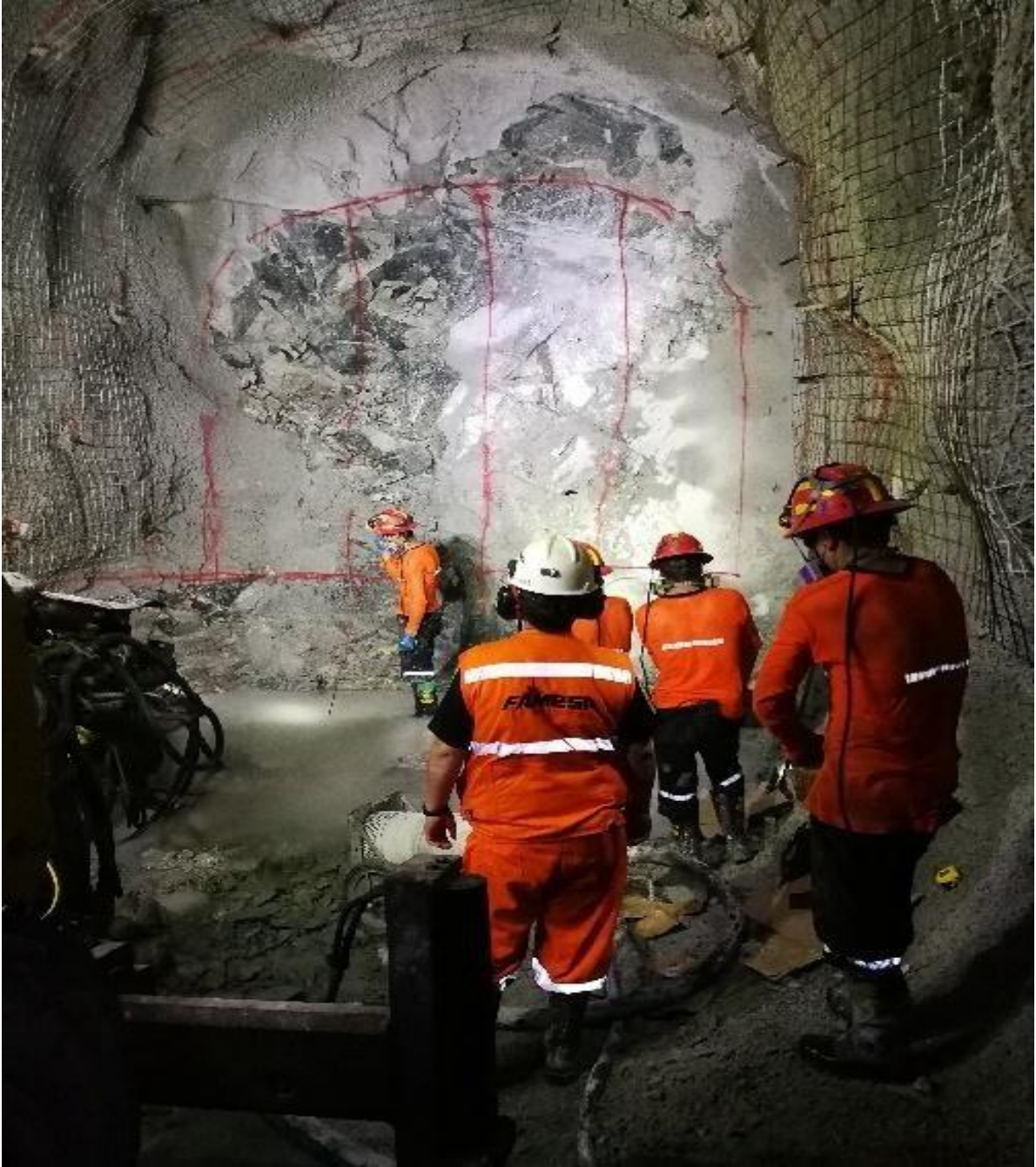
Figura 41 — Trazado de la malla de perforación, en la profundización de la rampa Patrick IV
