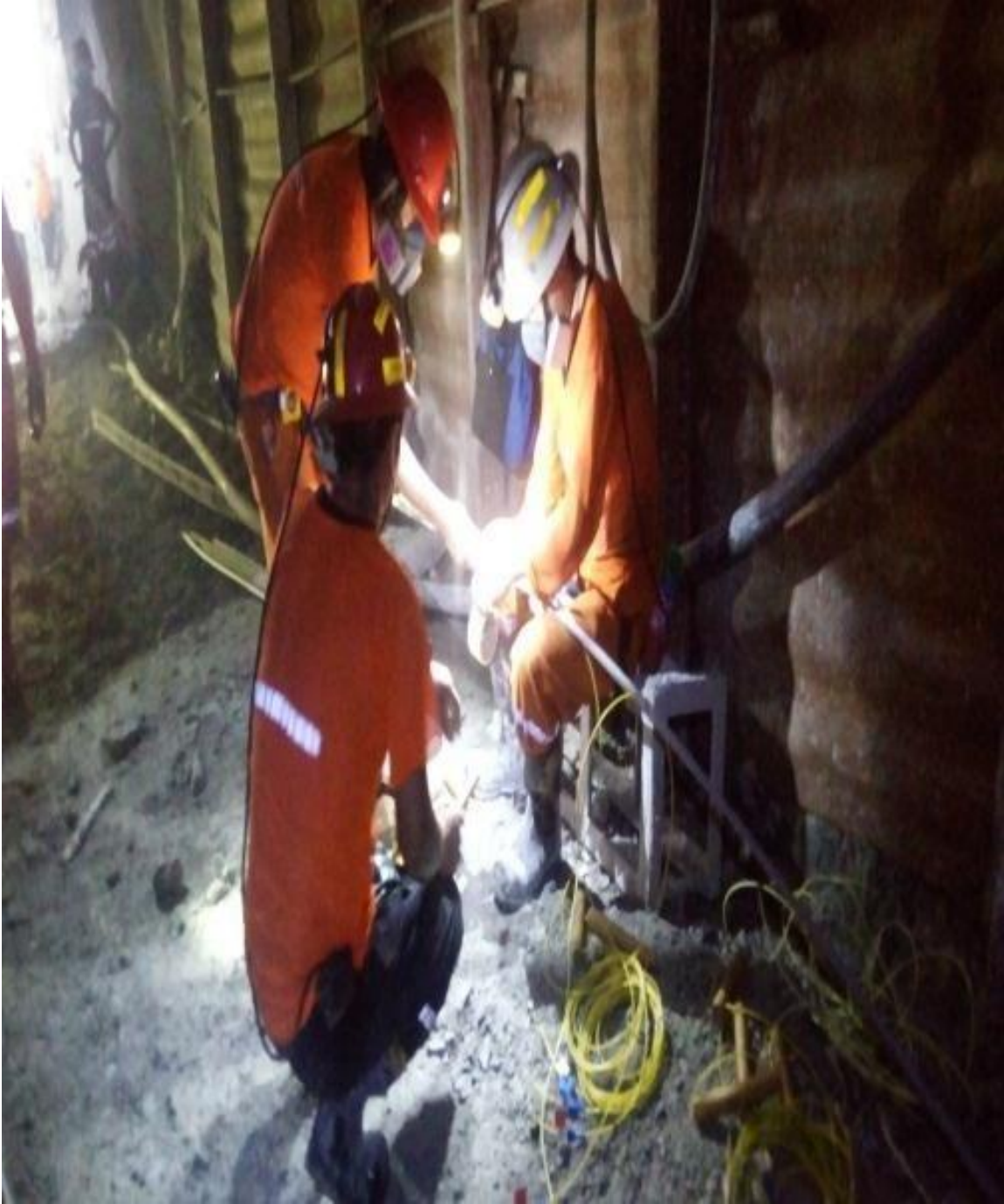
Figura 39 — Preparación de las cañas para la voladura de controlada de contorno en la profundización de la Rampa Patrick IV
