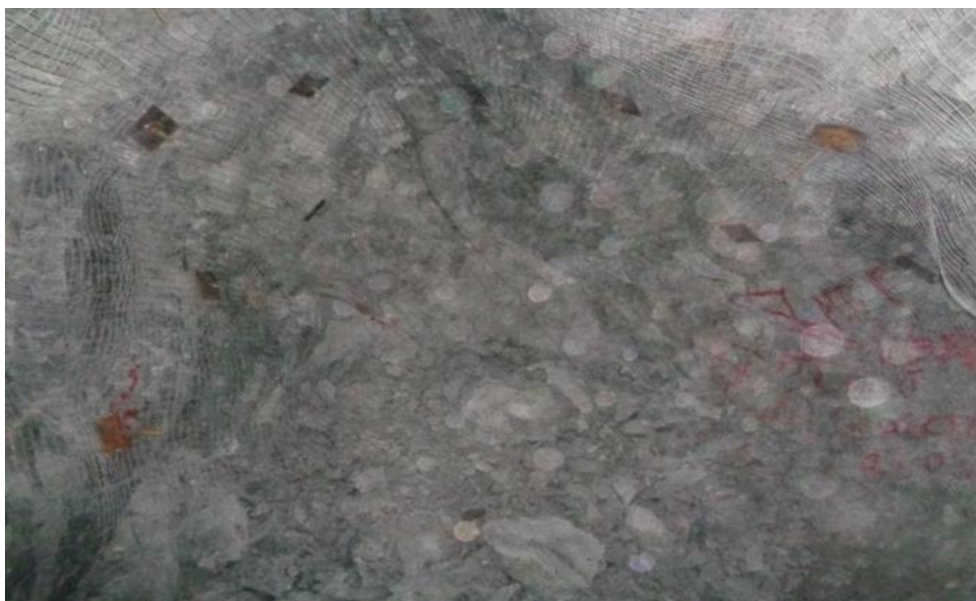
Figura 19 — Estallido de rocas regular en la Rampa 7040 por ambos hastiales
