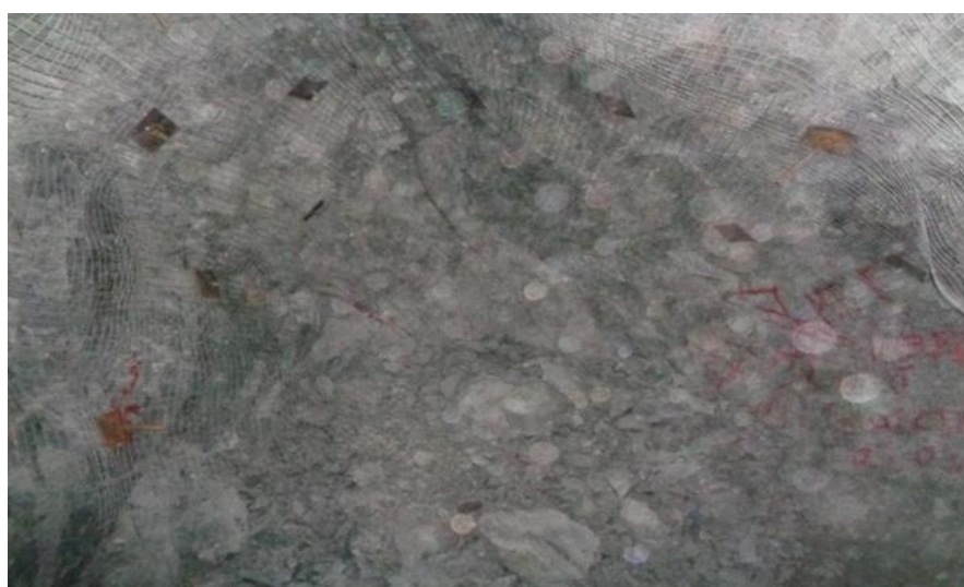
Figura 21 — Estallido de rocas en la Rampa 7040
