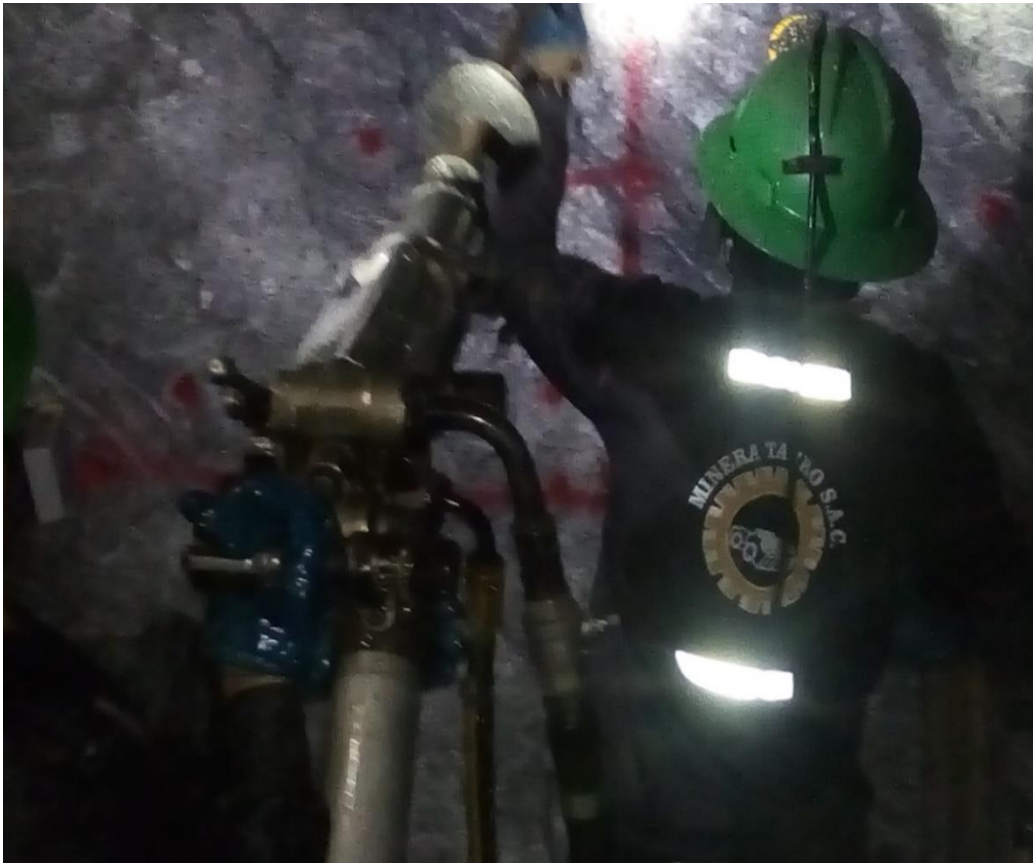
Figura 49 — Realizando perforación, para colocación escudo en el frente de la labor RP 7040
