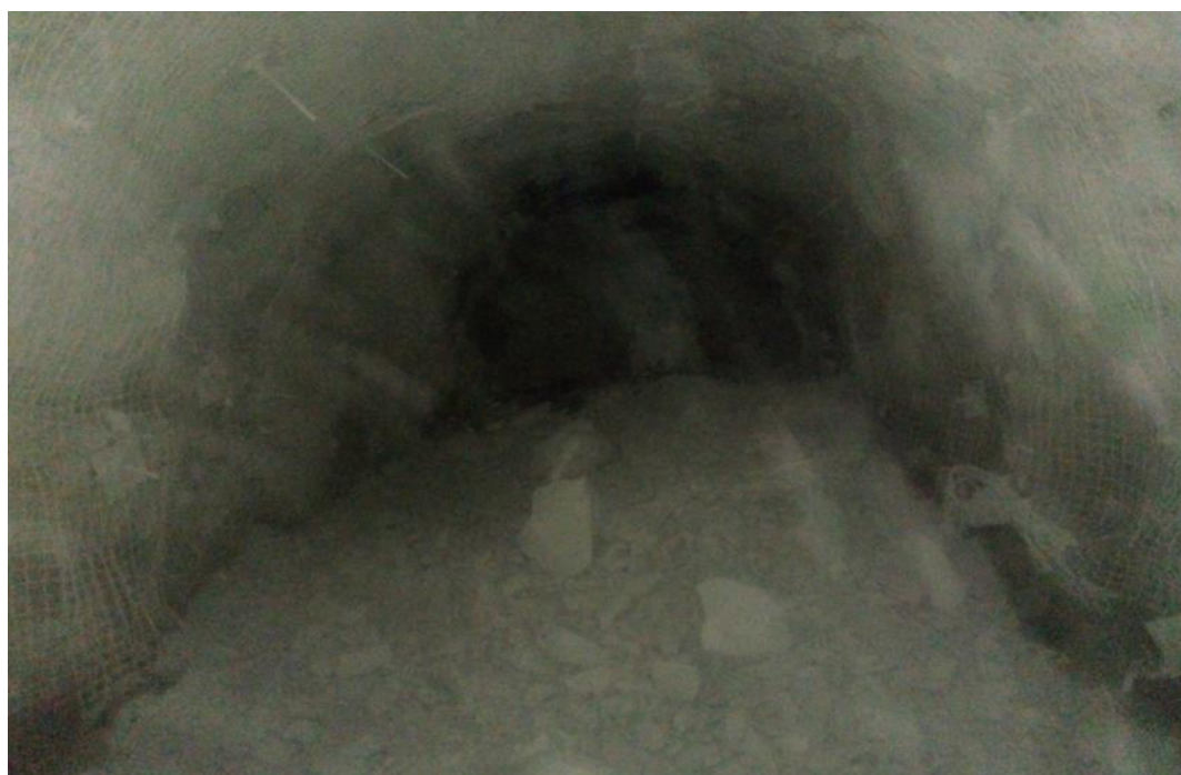
Figura 17 — Después de ocurrido Relajamiento de rocas en la rampa 7040
