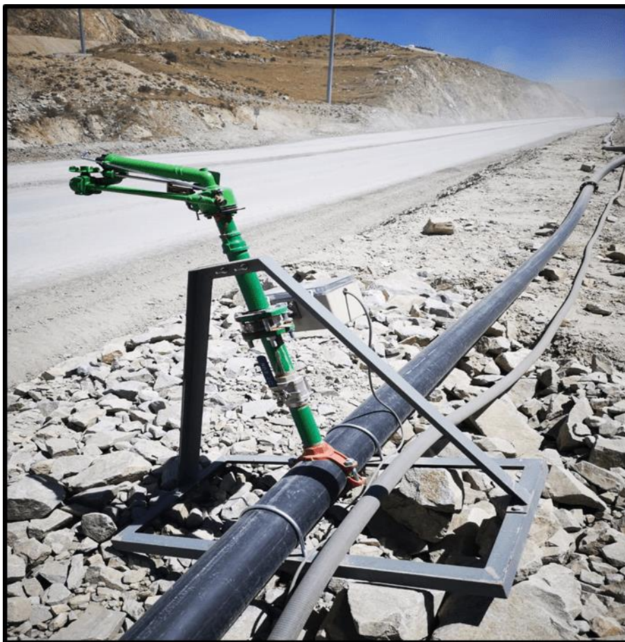
Figura 4— Instalación de cañones supresores de polvo Extraído de: Unidad Minera las Bambas
