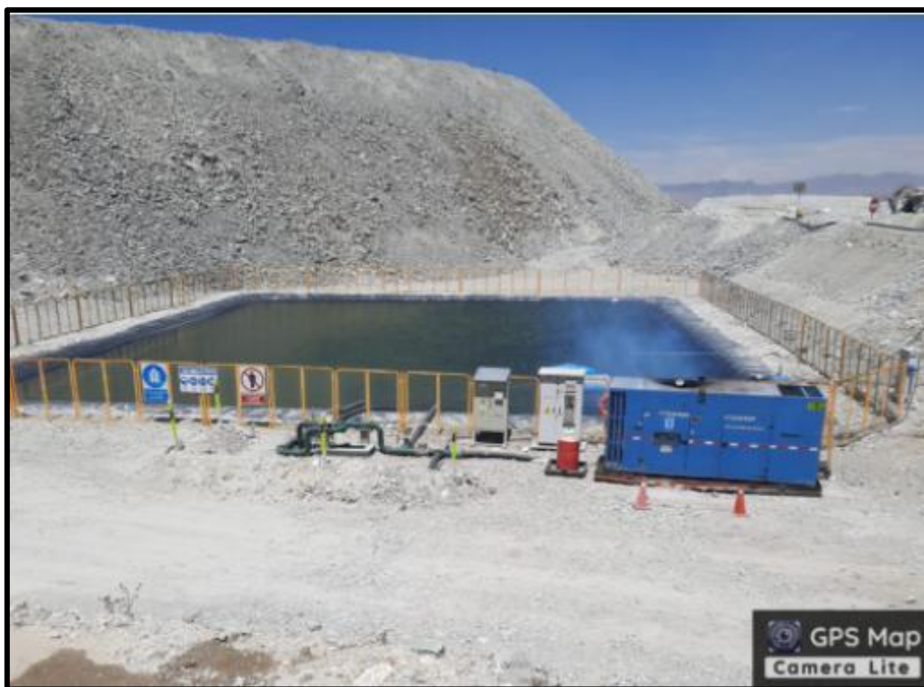
Figura 28—Sistema de abastecimiento de camiones cisterna (garzas)
