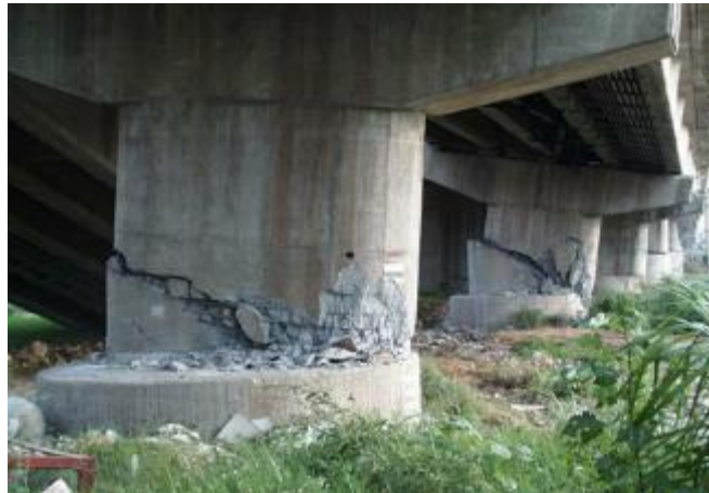
Figura 5 — Falla por corte en pilar del puente
