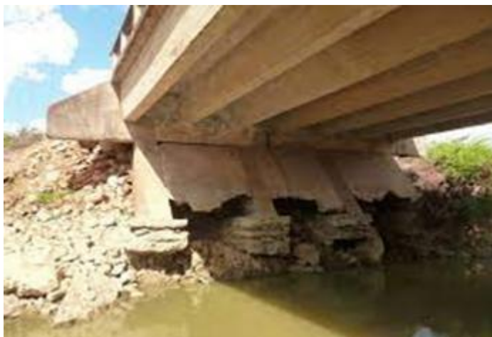
Figura 6 — Falla por socavación en estribos
