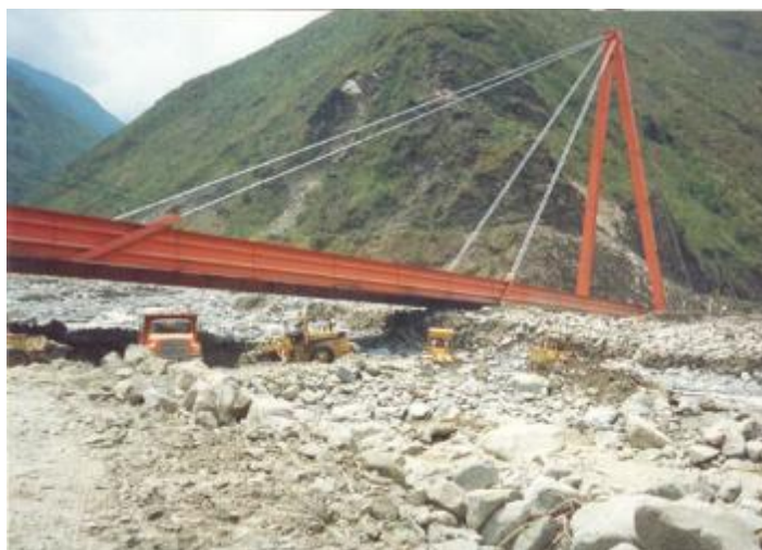
Figura 9 — Colapso de puente Yanango Tarma
