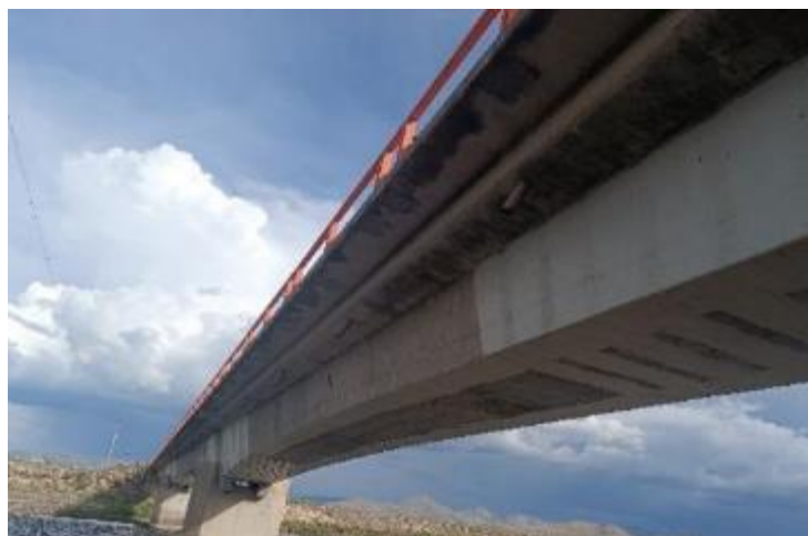
Figura 47 — Grietas, por la infiltración de agua en la cara inferior del tablero
