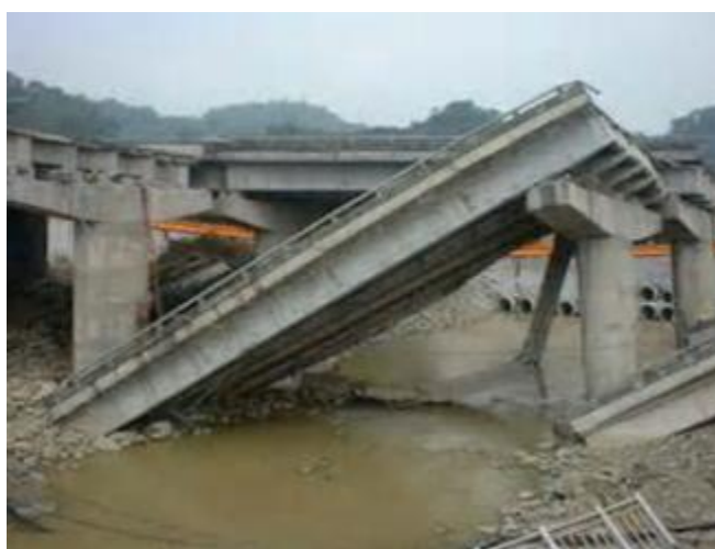
Figura 4 — Falla del tablero de puente por terremoto
