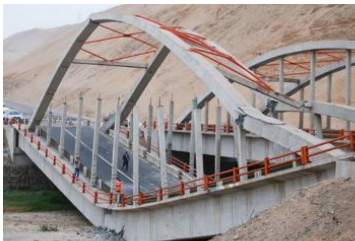
Figura 7 — Falla por insuficiencia de longitud del tablero
