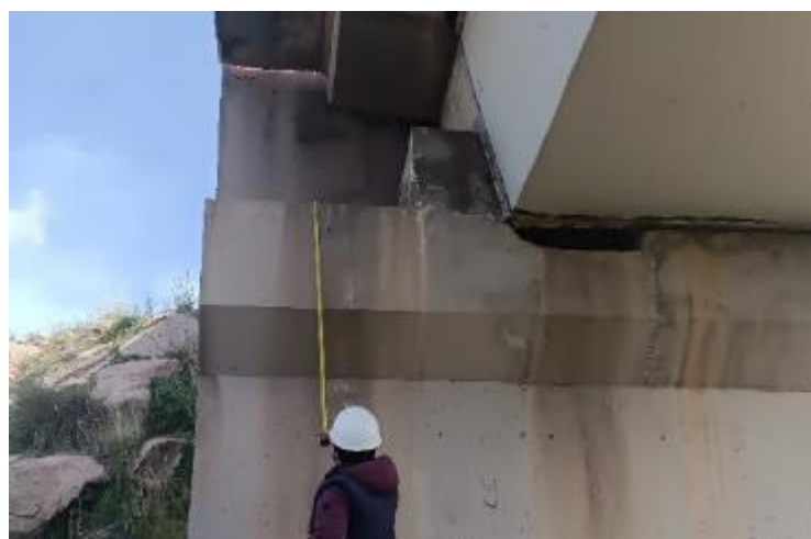
Figura 48 — Inflorescencia, por la infiltración de agua en la cara inferior de la vereda
