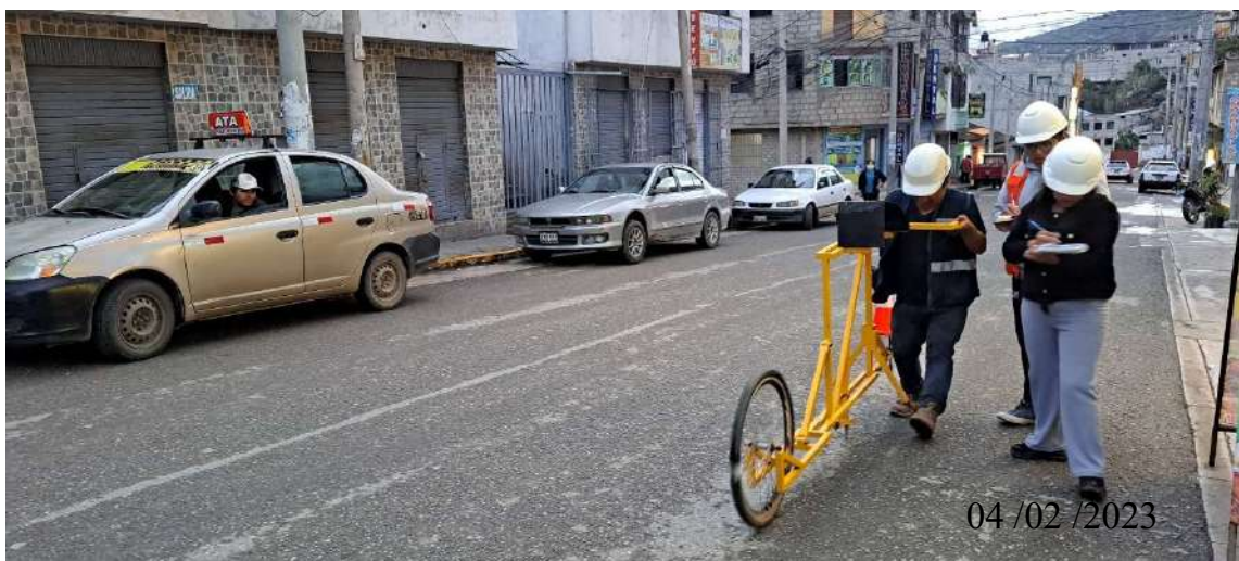
Fotografía 2 – Medición con el Rugosímetro de Merlín de las desviaciones o depresiones en el tramo 2 carril izquierdo en la progresiva 0+070 a 0+470.
