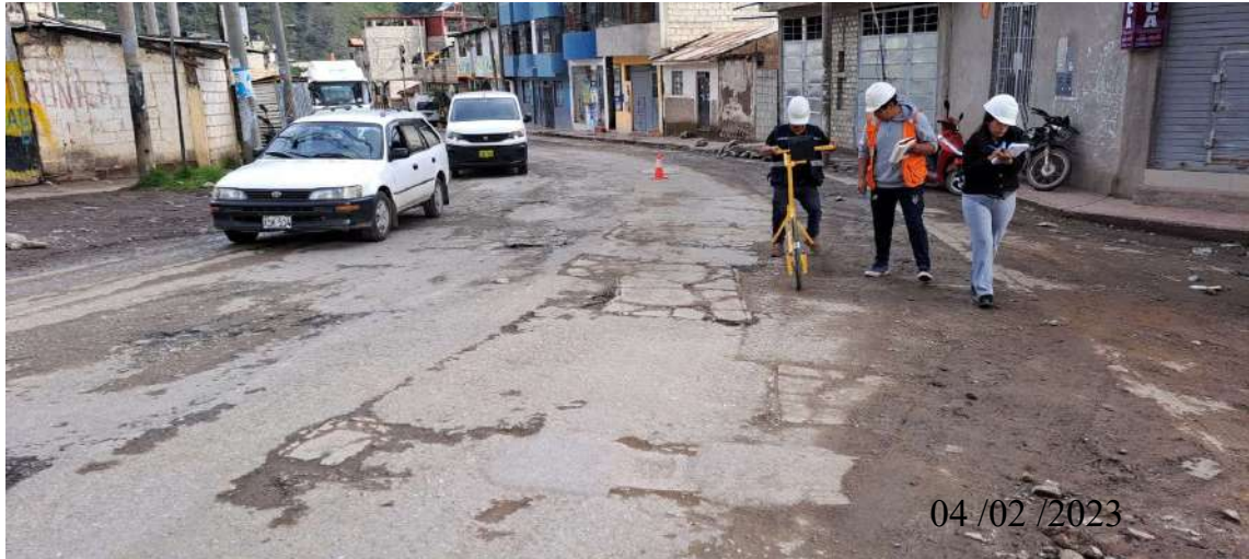
Fotografía 1 – Medición con el Rugosímetro de Merlín de las desviaciones o depresiones en el tramo 1 carril izquierdo y verificación de bacheo, piel de coco drilo y presencia de parches en la progresiva 0+000 a 0+400.
