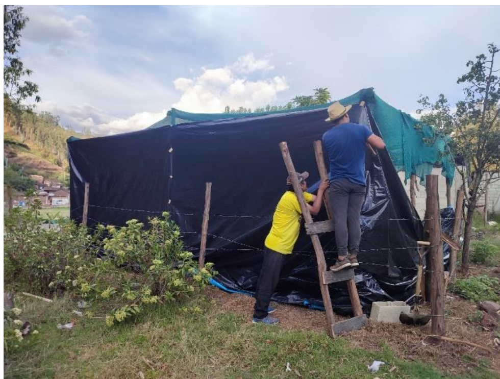
Figura 17 — Forrado de caseta
