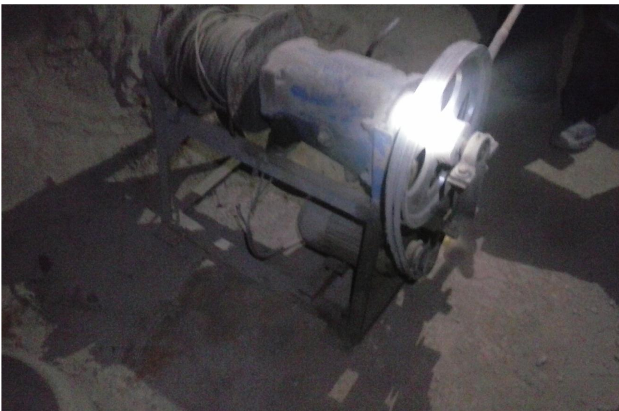
Fotografía 12: Pique B-5, Winche de izaje en interior mina.
