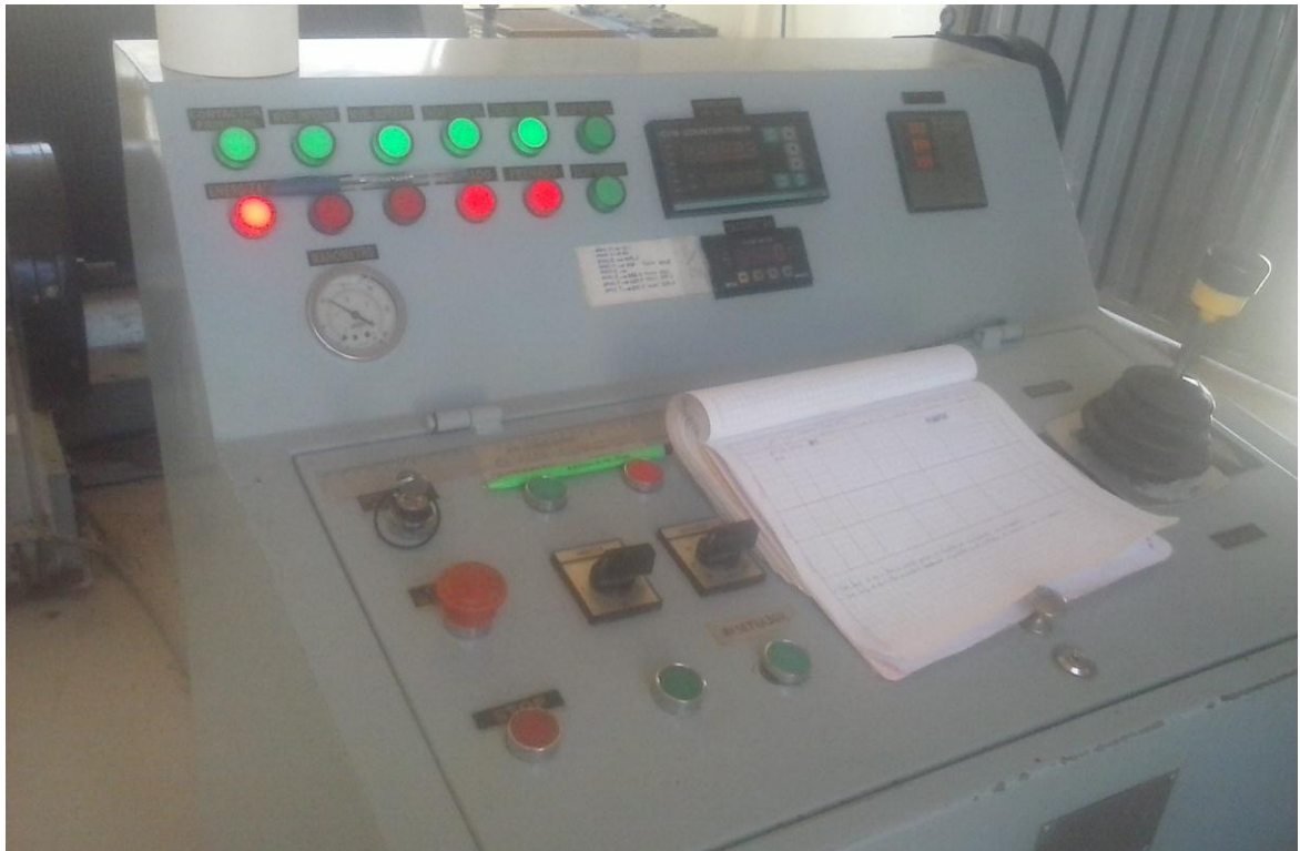
Fotografía 03: Pique B-4, Consola de mando de winche.
