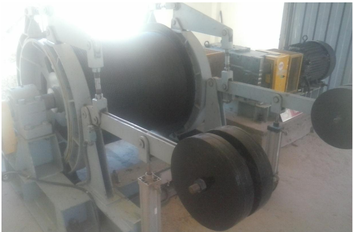
Fotografía 04: Pique B-4, Tambora de izaje y motor de winche de 75 HP
