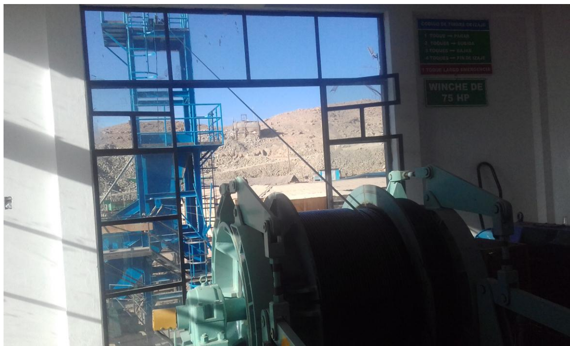
Fotografía 10: Pique B-5, Tambora de izaje Winche 75 HP.
