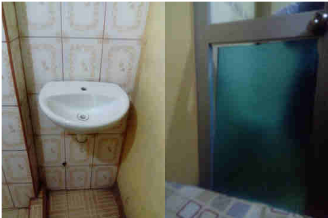
Imagen 9. Los servicios higiénicos tienen deficiencias y averías.
