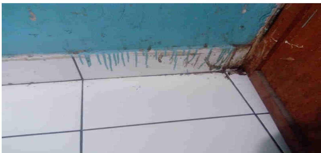
Imagen 4. Las habitaciones de los hospedajes no se encuentran limpias y están en mal estado.
