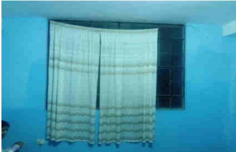
Imagen 5. Se presencia en las habitaciones el mal estado de las cortinas
