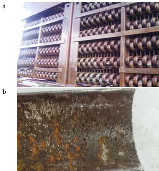
Fig. 2. Corrosión de tubos serpentines: a) serpentín, b) Corte transversal tubos.
