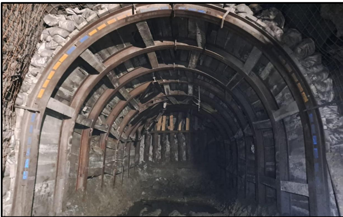
Figura 55 — Ventana de explotación con preparación concluida.
