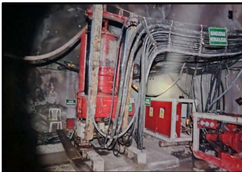
Figura 45 — Ubicación del Raise Boring en el nivel 21A.
