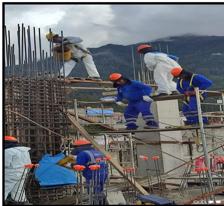
Figura 30 — Incidentes causados por negligencia de los obreros.
