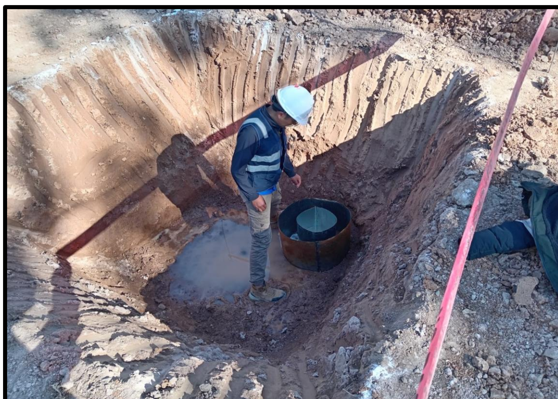
Figura 33 — Observación de filtración de agua en fondo de reservorio
