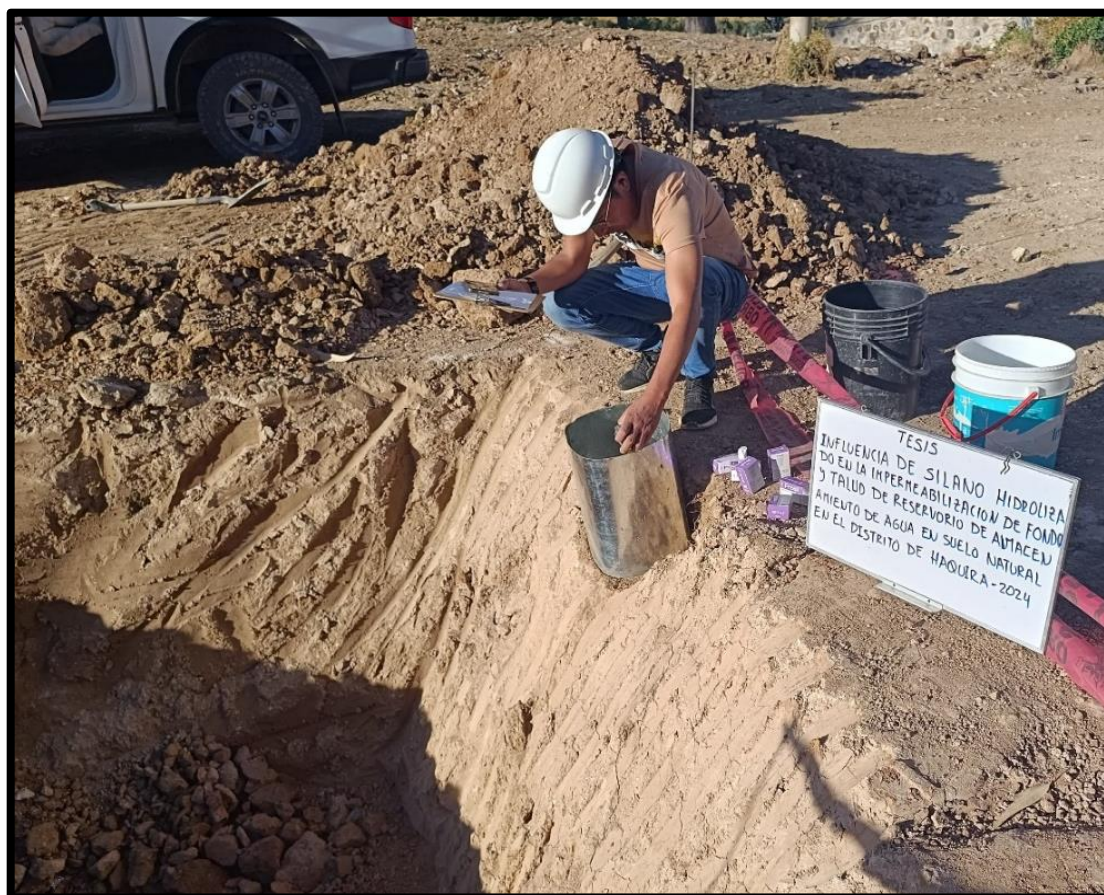
Figura 24 — Colocación de anillo para el ensayo sin tratamiento en talud de reservorio
