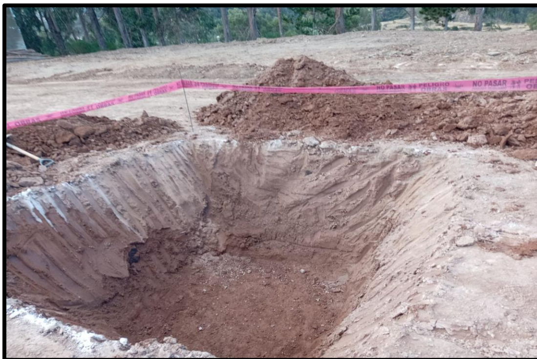
Figura 20 — Se observa el reservorio para realizar los ensayos
