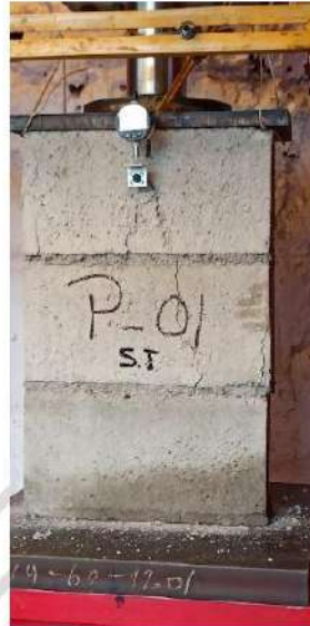
Imagen 05: Muestra el tipo de falla de la pila sin
