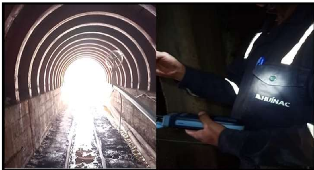
Figura 20 — Velocidad Flujo de aire en la Galería Caira Nv 04
