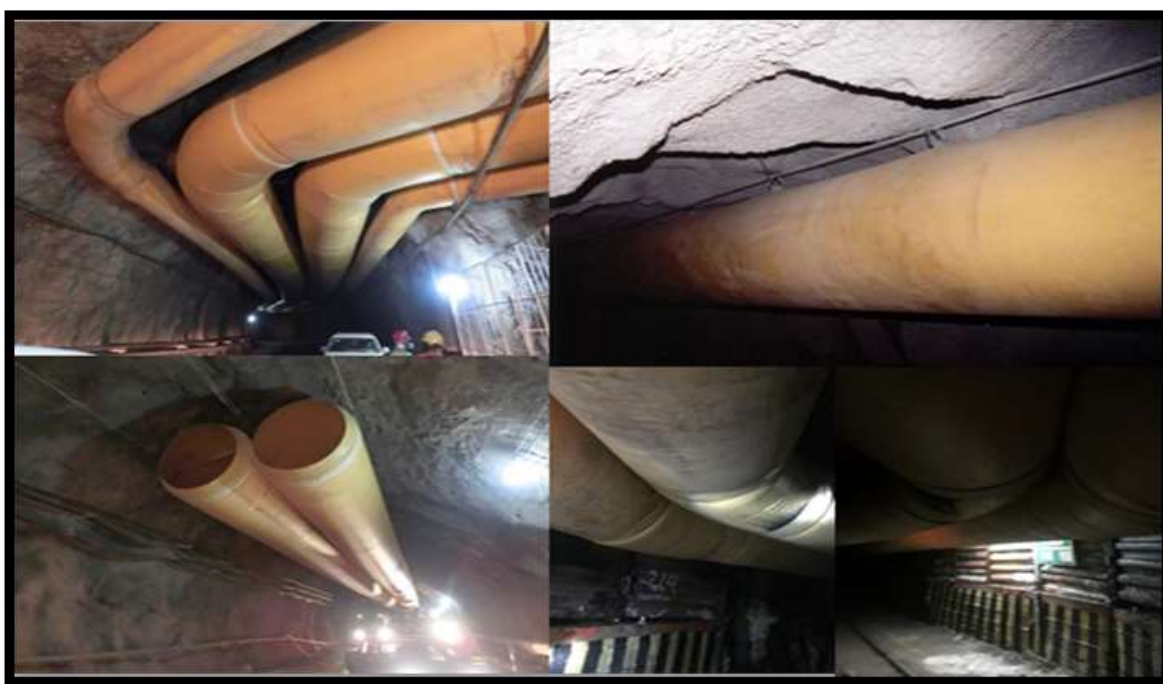
Figura 11 — Manga de Ventilación
