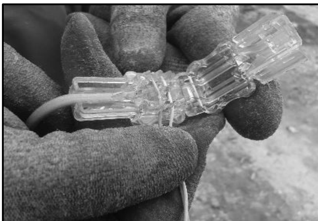
FOTO N° 17: Amarre correcto entre el digishot y el cable eléctrico de cobre.
