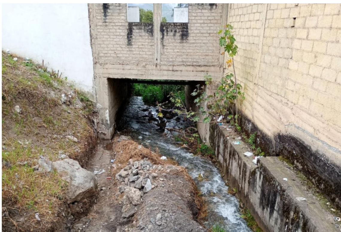
Figura 15 — Construcción de vivienda sobre el cauce.
