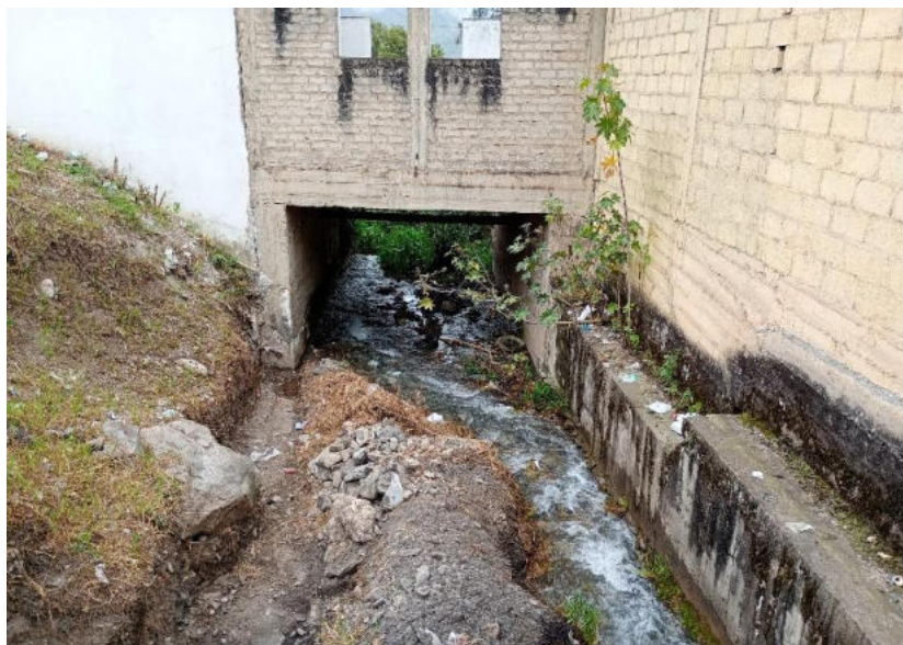
Figura 15 – Canalización de la quebrada Sahuanay, con estructuras no adecuadas
