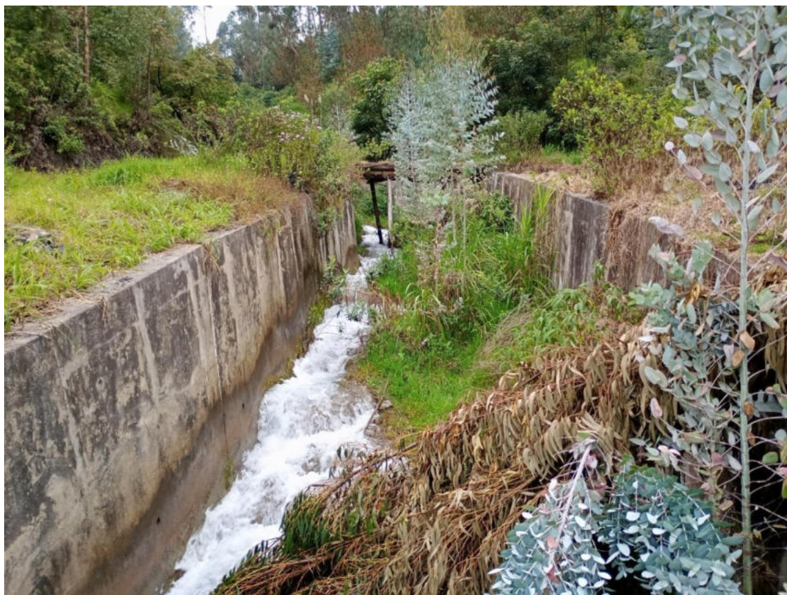
Figura 12 — Canal sin mantenimiento.
