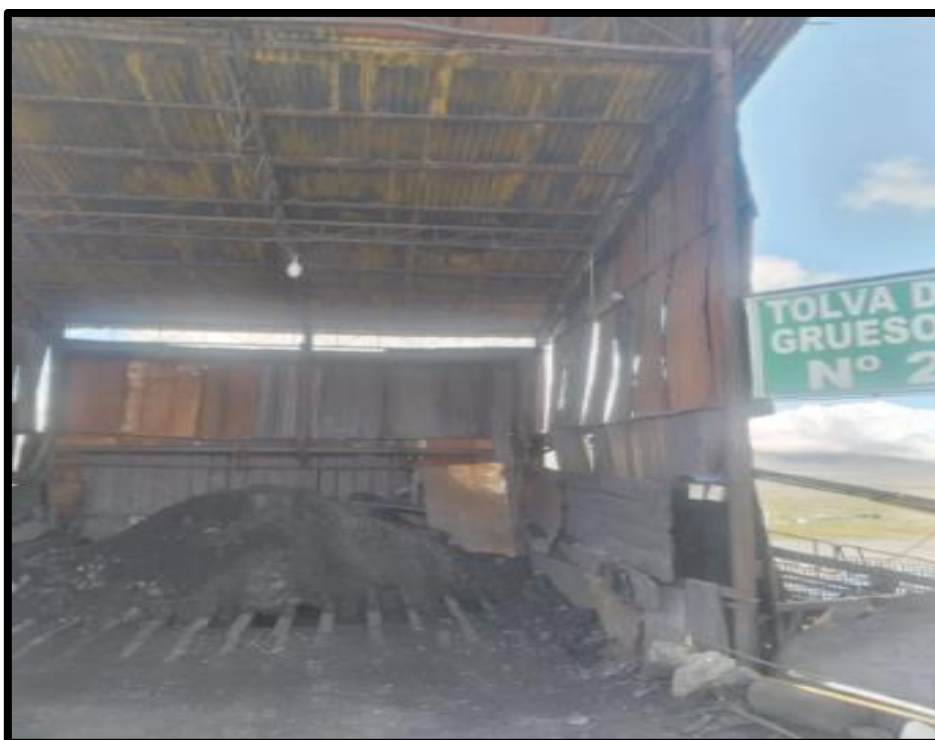
Figura 45 — Tolva del chancado primario
