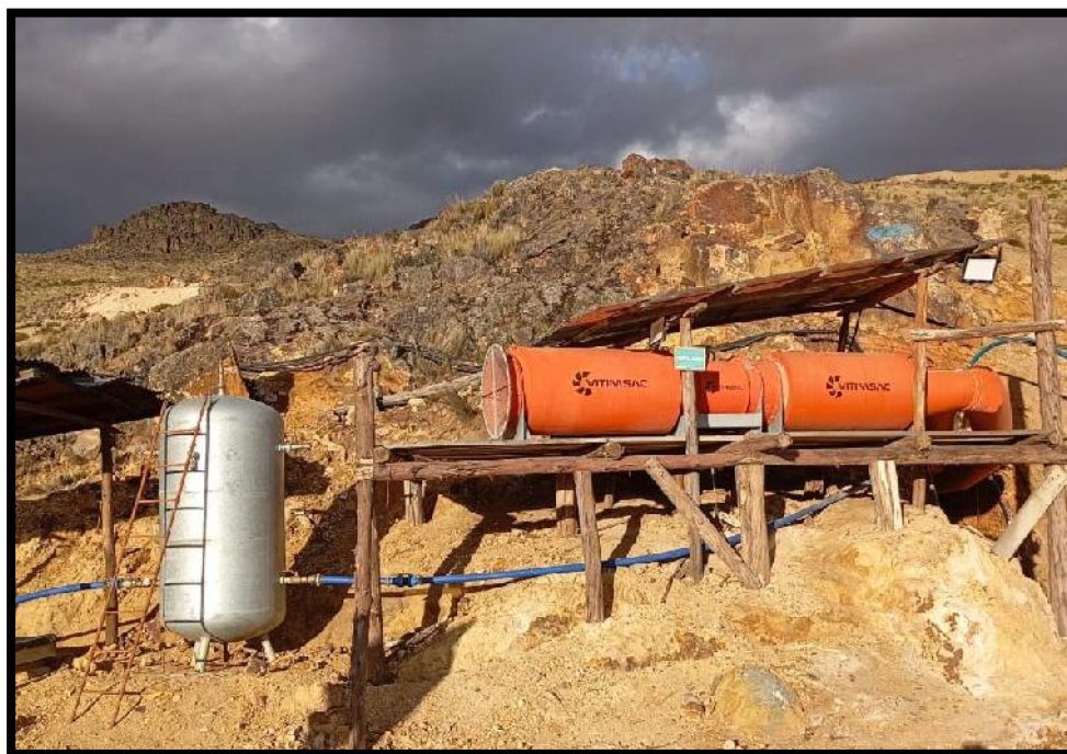
Figura 9 — Sistema de ventilación en la U.O. Pampamarquino
