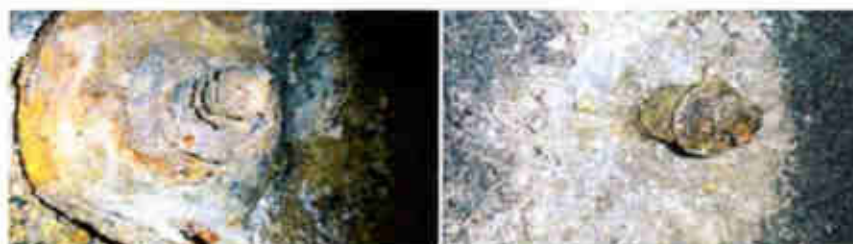
Fotografía 4. 4. Pruebas de tracción de "rs bolt" corroídos.
