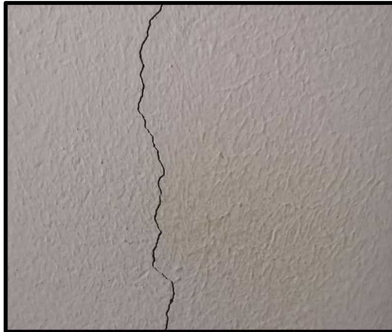
Figura 76 — Fisuración en pared
