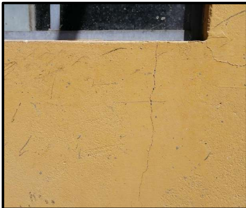
Figura 77 — Fisuración en esquina de una venta
