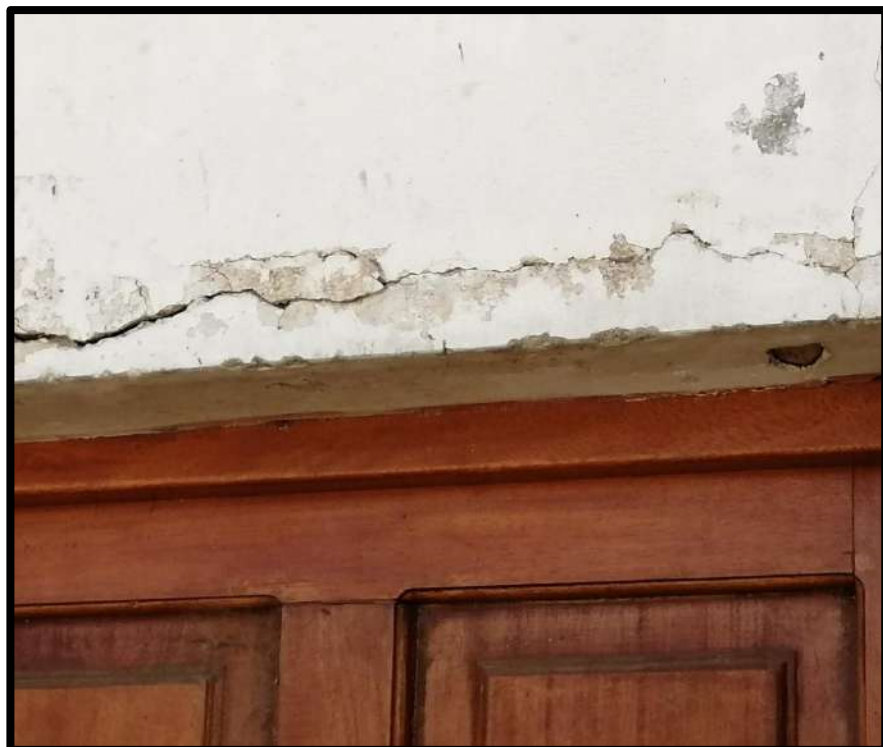
Figura 79 —Desprendimiento separación de las capas de concreto
