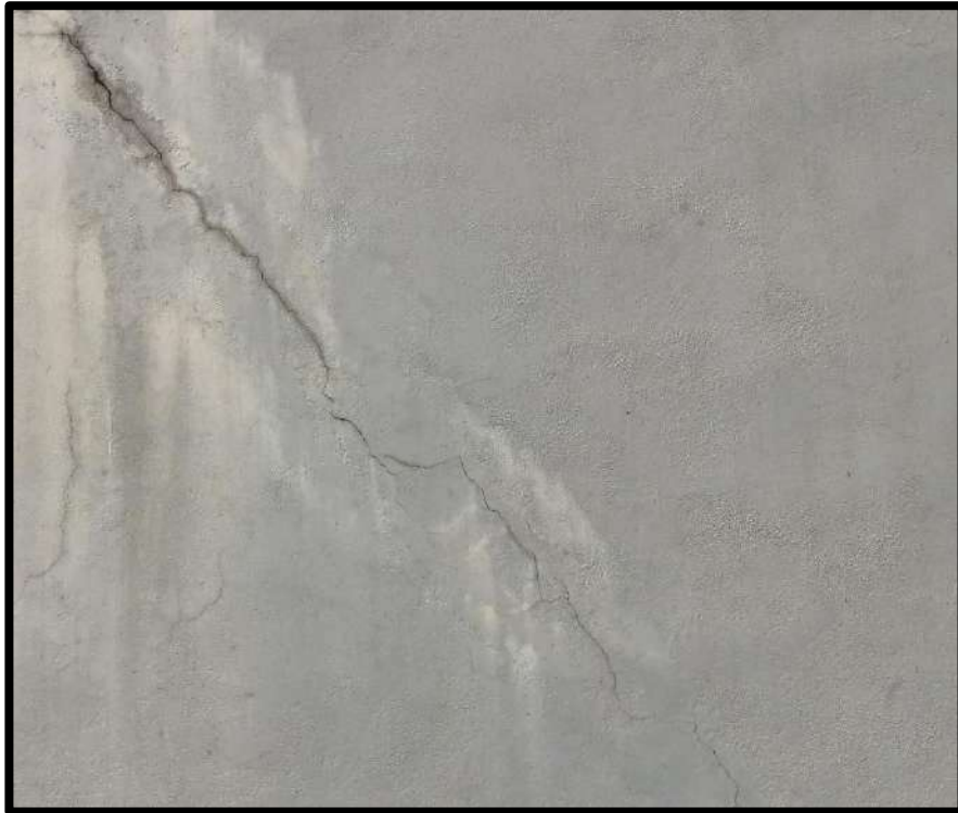
Figura 78 — fisuración en pared
