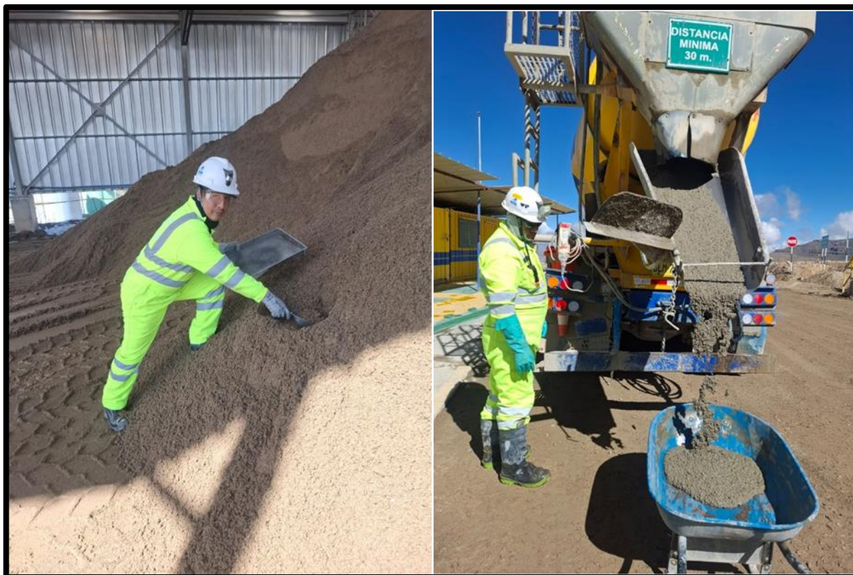
Figura 49 — Muestra de agregado y calidad de concreto
