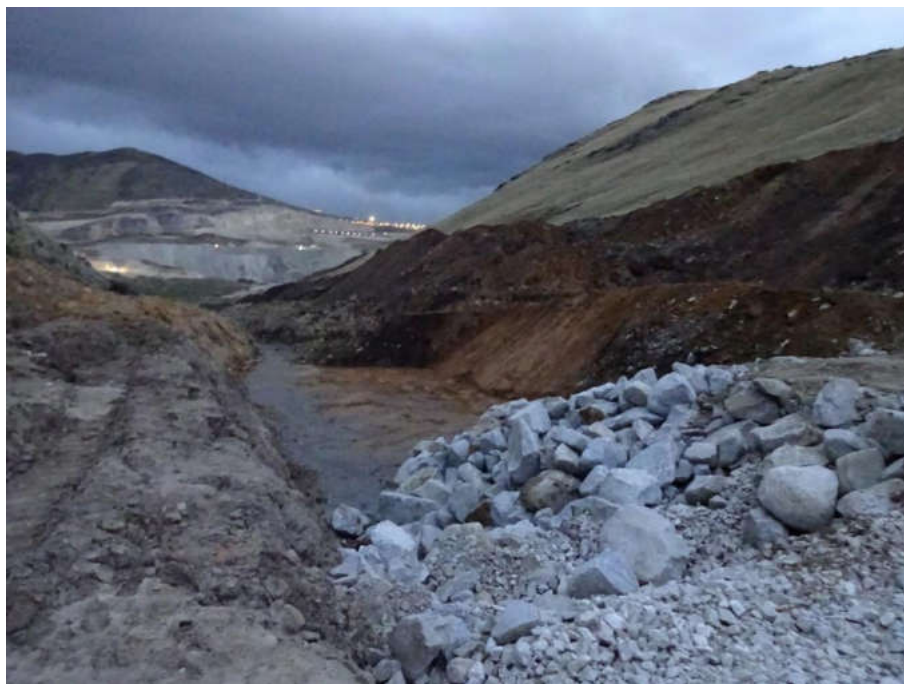
Imagen 28. Evidencias del funcionamiento del subdren P-04 Botadero Ferrobamba
