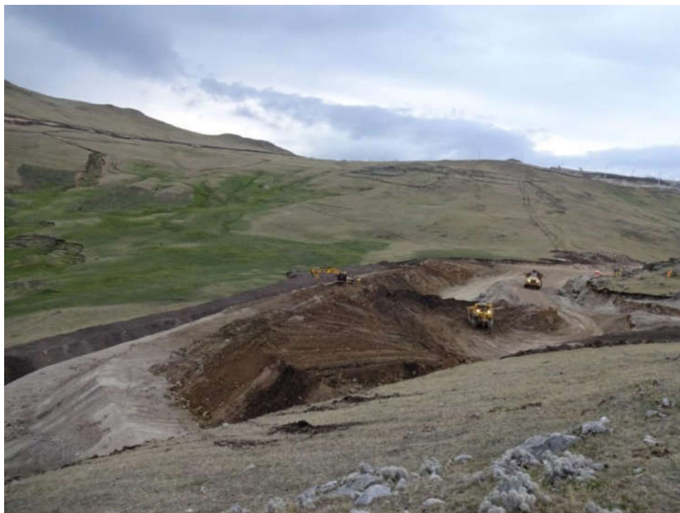
Imagen 16. Depósito de material inadecuado proveniente de subdren P 04.
