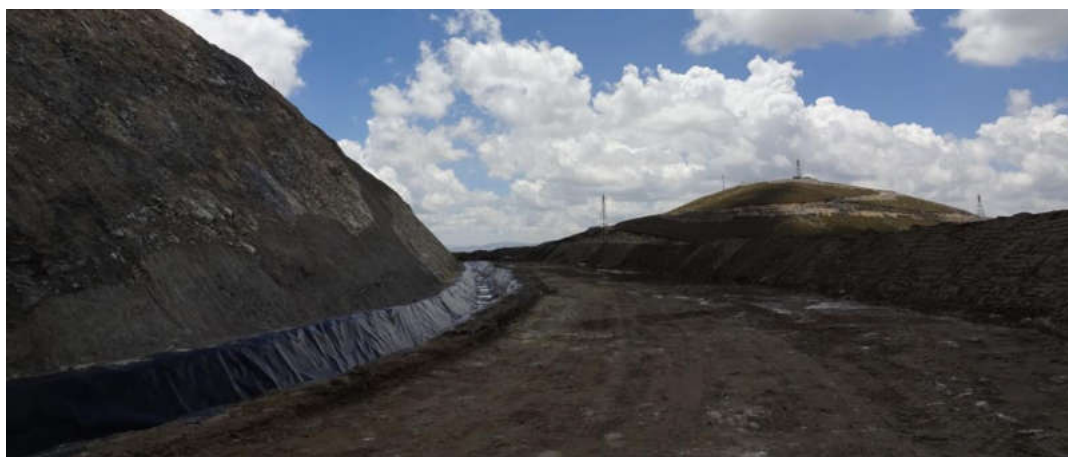
Imagen 8. Canal de coronación Botadero Ferrobamba
