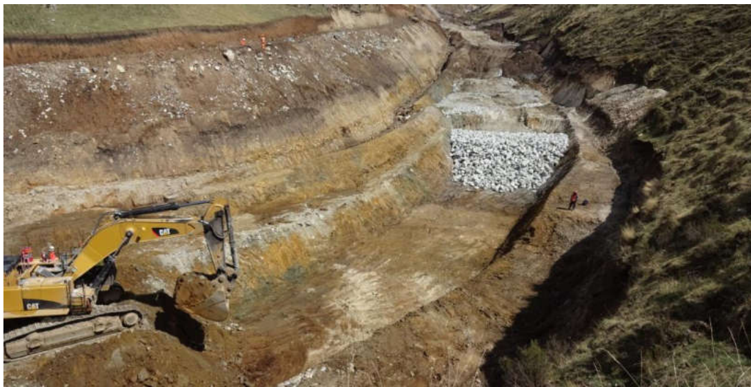
Imagen 11. Subdren Principal P-04 Botadero Ferrobamba
