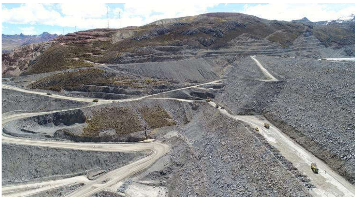
Figura N° 49: Accesos Temporales de la tercera etapa del recremento de la presa de Relaves
