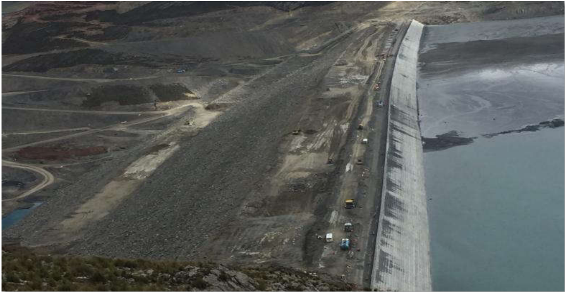
Figura N° 26: Tramo de la Ruta Crítica para el transporte de material tipo 3 para el recrecimiento de la presa de relave Etapa 3°
