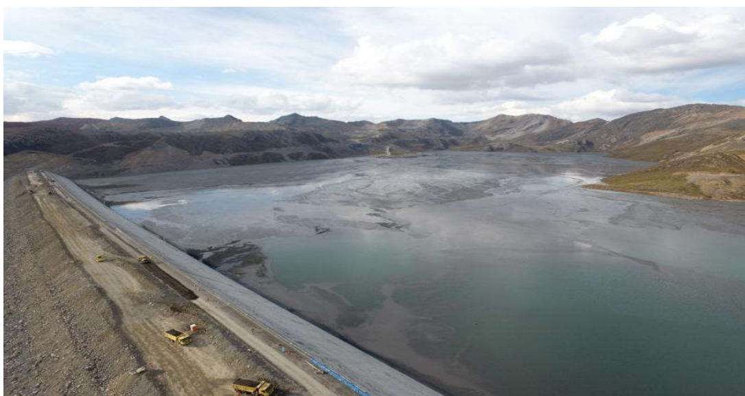
Figura N° 13: Presa de Relaves – Toromocho
