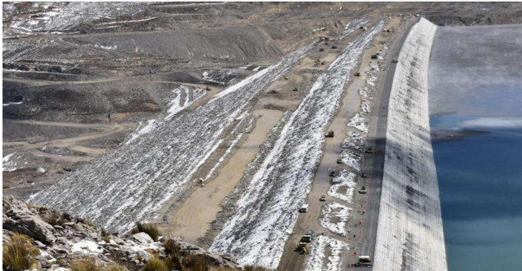
Figura N° 15: Equipos de Acarreo para la Presa de Relaves – Toromocho
