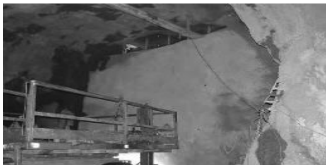
Figura Nro 15: Open -top relleno barricada. La parte superior abierta permite la ventilación adecuada de aire atrapado.
