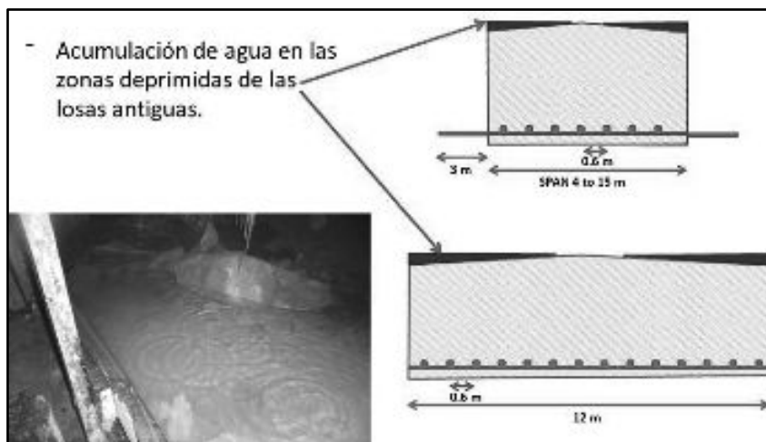
Figura Nro. 17: Empozamiento de agua en zonas deprimidas de las losas
