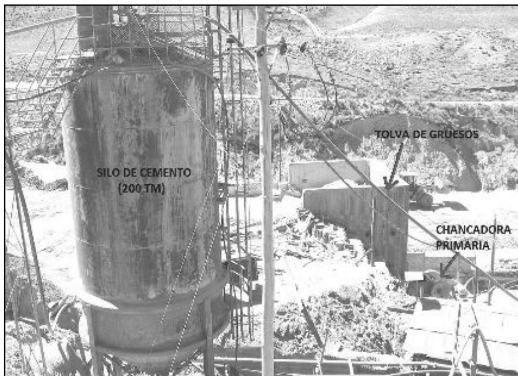
Figura Nro. 32: Las instalaciones y equipos de planta chancadora en U. P. ANDAYCHAGUA
