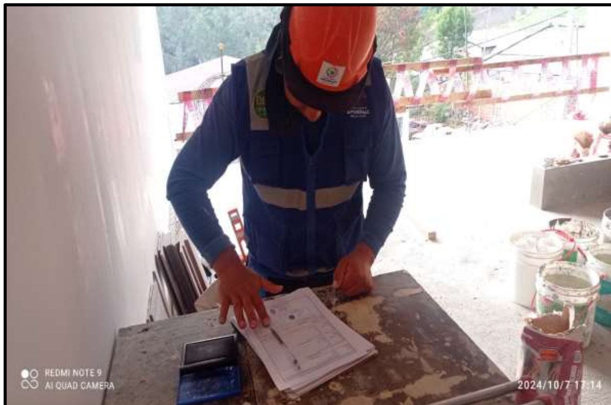
Figura 33 — Validación del avance diario mediante la firma y huella en la ficha de rendimiento del peón de la cuadrilla N°04 como evidencia comprobatoria
