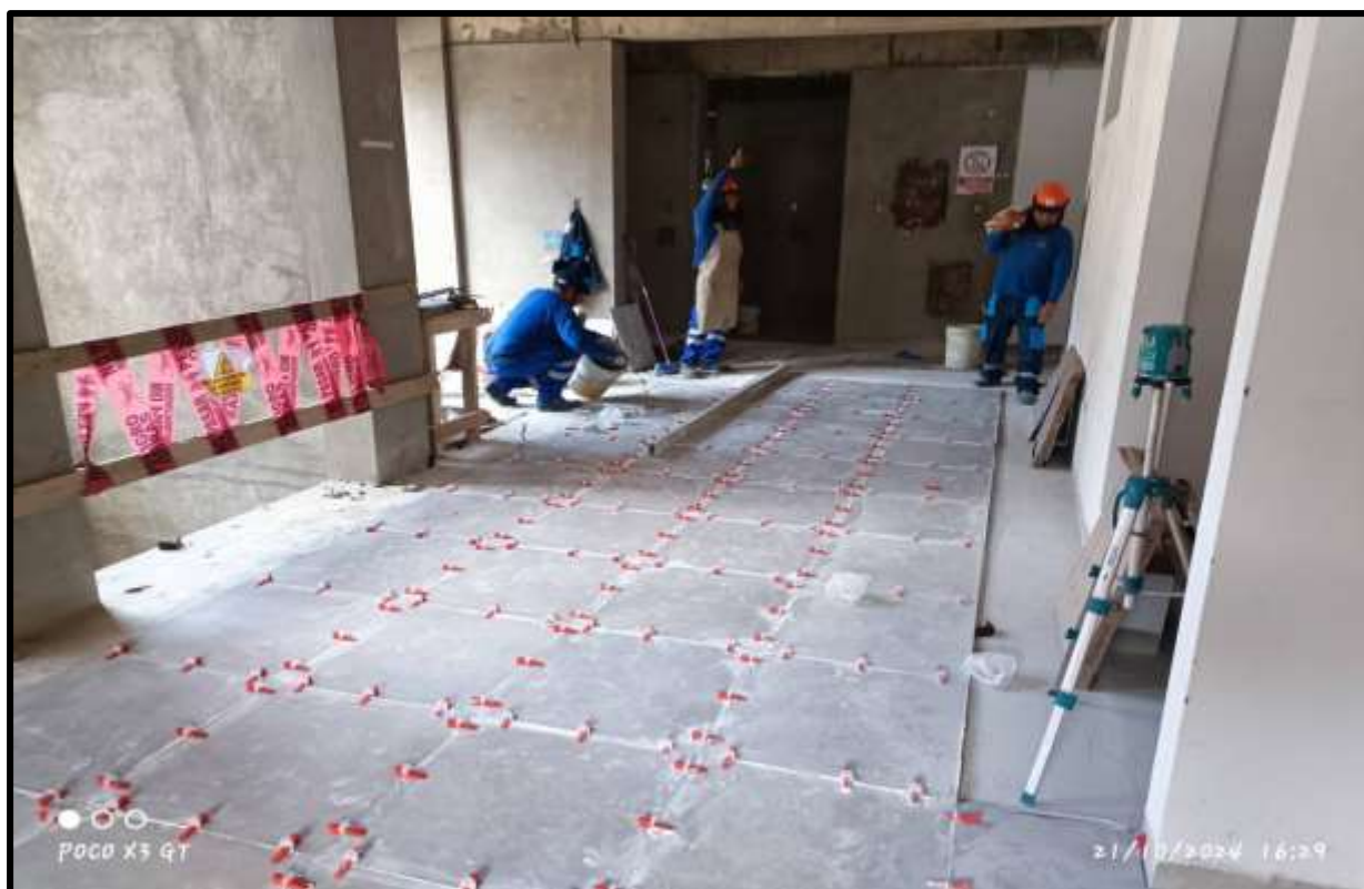
Figura 40 — Anotación y verificación de avance del día de la cuadrilla N°04 en HALL – 2DO NIVEL; observándose que enchaparon porcelanatos enteros sin cortes.
