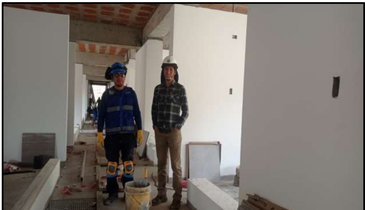
Figura 27 — Verificación del rendimiento y coordinaciones con la cuadrilla N°01 en el área de circulación del 2do Nivel del Bloque II
