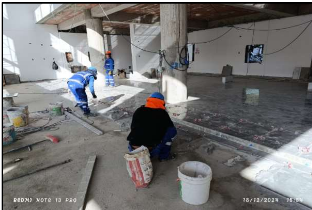
Figura 43 — Anotación del rendimiento y verificación de enchapados de las cuadrillas N°06 y 07 en el HALL DE ATENCIÓN del 1er Nivel, mostrándose el enchapado de porcelanatos enteros
