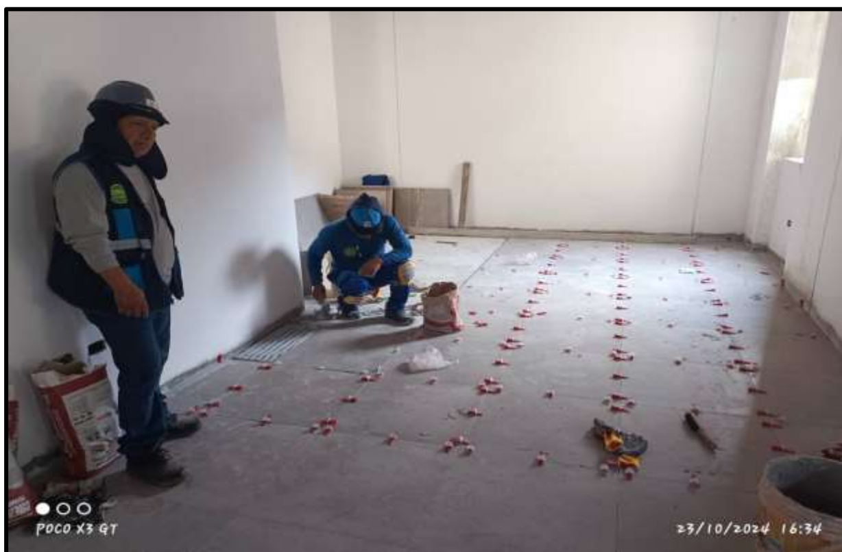
Figura 41 — Anotación y verificación de avance del día de la Cuadrilla N°04 en OFIC. INFRAESTRUCTURA 2DO NIVEL; observándose la existencia de cortes en los extremos
