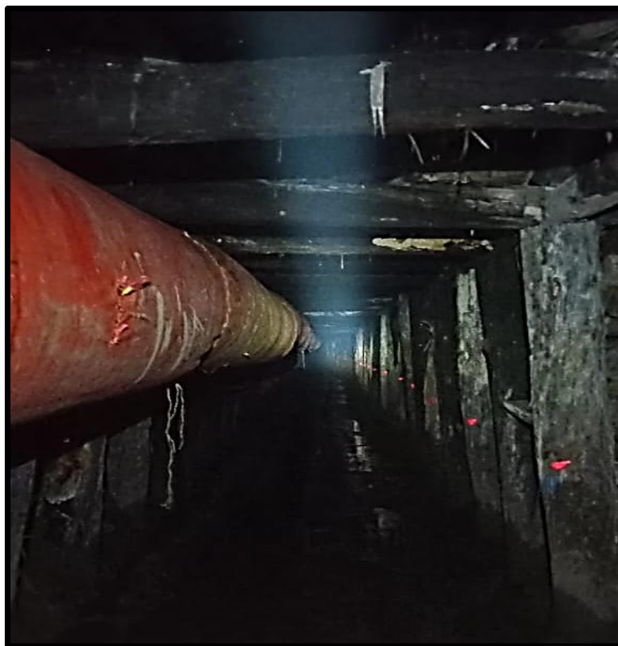
Figura 31 — Ventilación en la cortada principal
