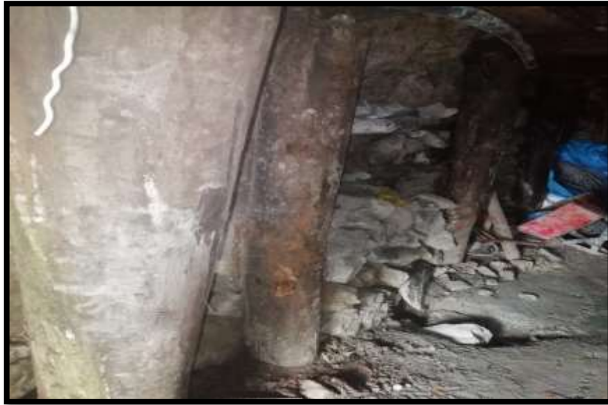
Foto IV-5: Caída y desestabilidad del enrejado y tirantes de la labor.
