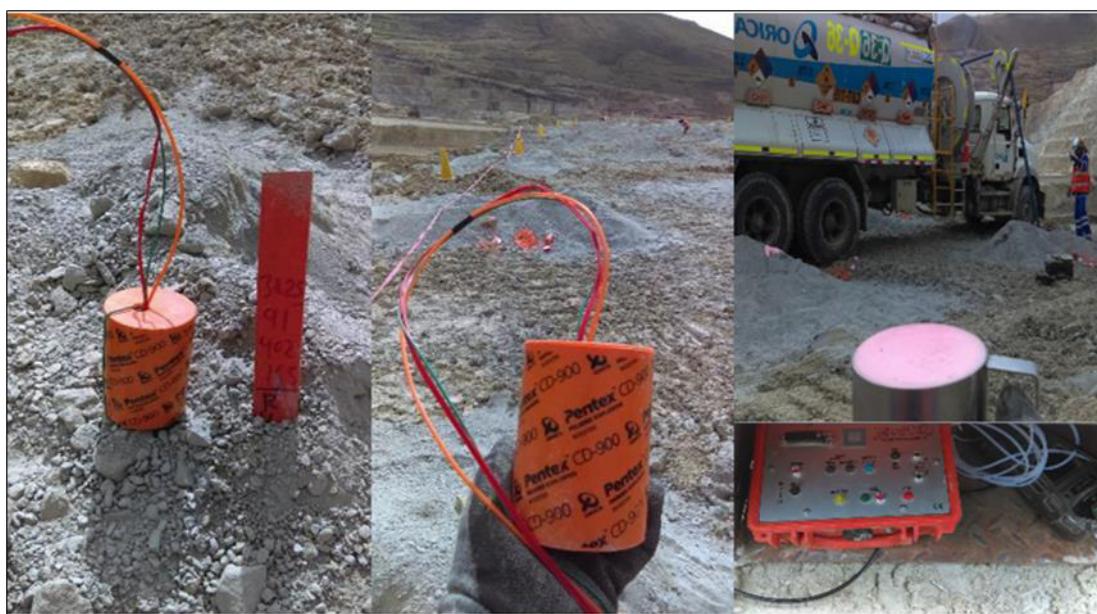
Fotografía 3-21: Instalación de cable resistivo (verde) junto al booster y líneas descendentes. Fuente: Asistencia Técnica (ORICA) “Las Bambas”
