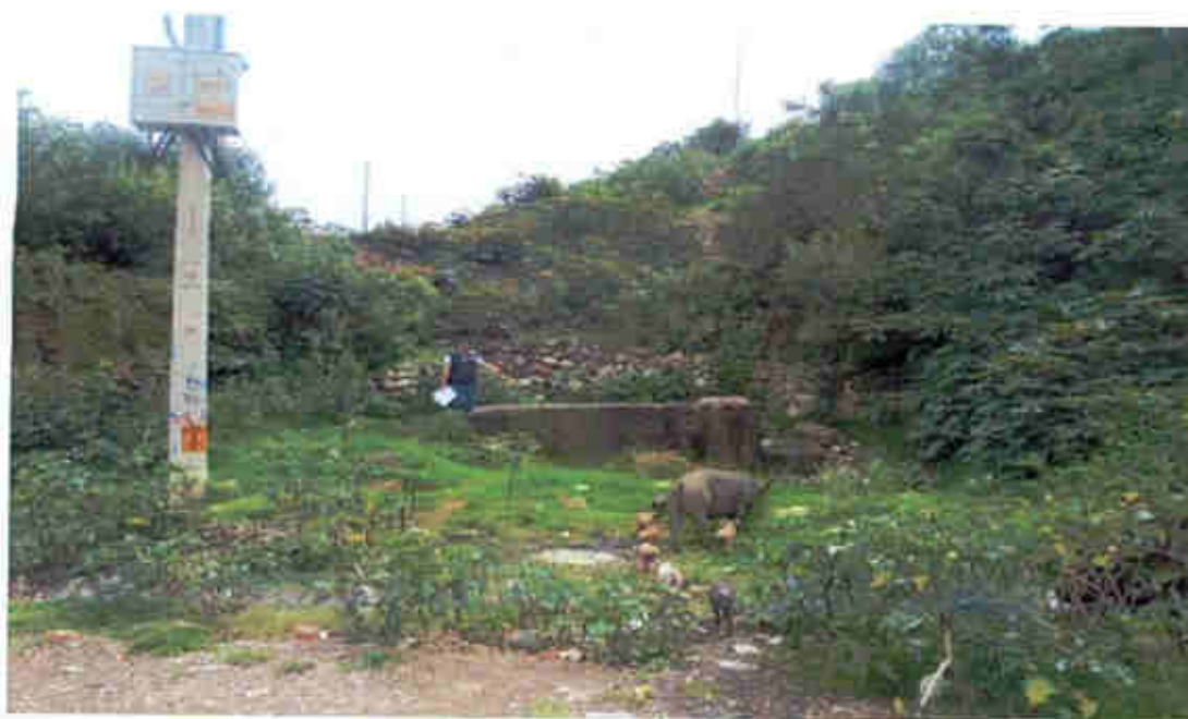
Figura 20. Estado crítico y en abandono del sistema de reservorio en la comunidad de Maucacalle, distrito de Tamburco.
