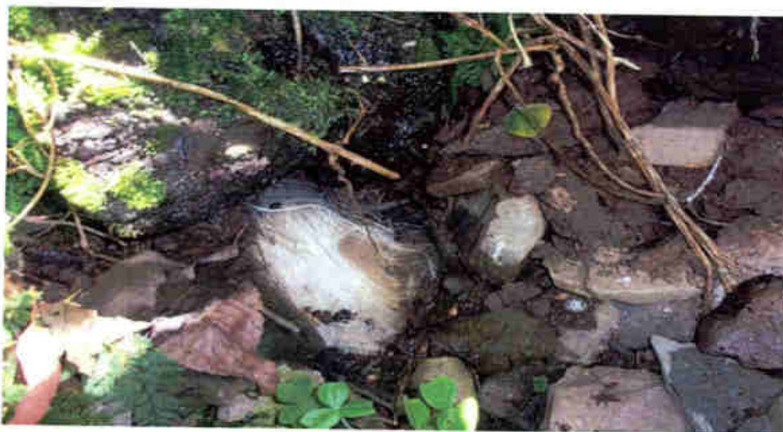
Figura 18. Captación en la comunidad de Ccallaspampa, distrito de Tamburo, en estado de abandono.
