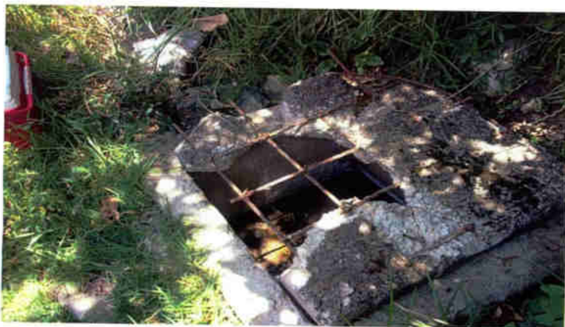
Figura 19. Estado crítico y en abandono del sistema de captación en la comunidad de Ccallaspampa, distrito de Tamburco.
