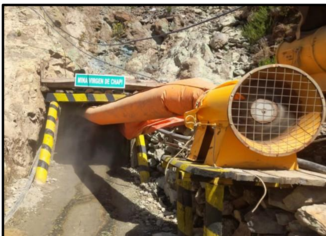
Figura 31 — Sistema de ventilación en la bocamina
