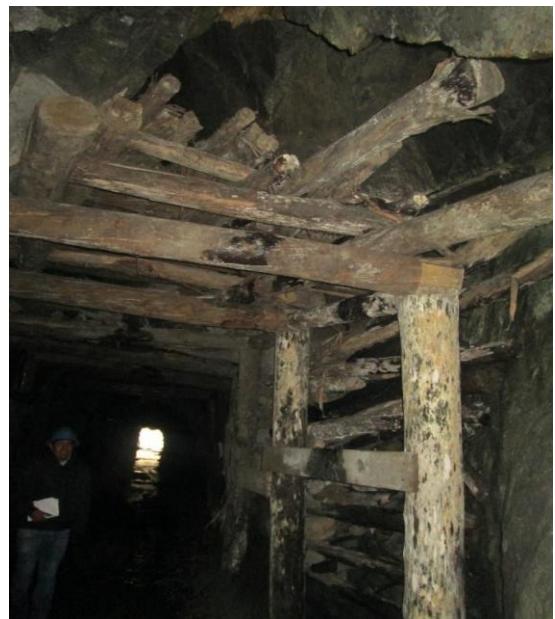
Foto 02: sostenimiento con cuadros de madera en la galería nivel 01 principales
