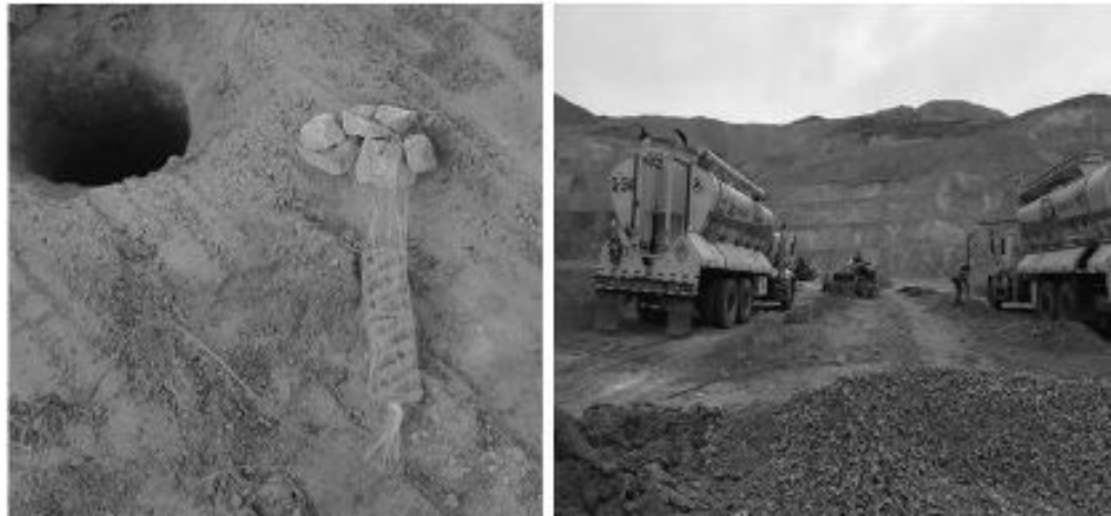
Figura 35. Primado de accesorios, explosivos y carguio de taladros con MMU Fuente: Elaboracion propia
