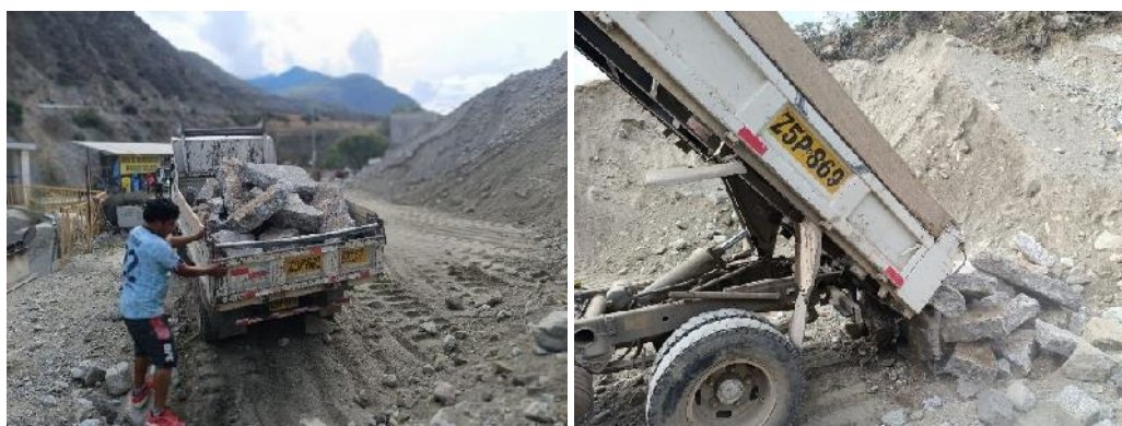
Figura 24 — Escombros de concreto
