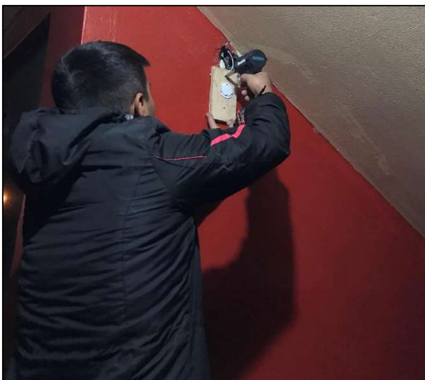
Figura 75 — Colocacion de la camara de seguridad en la vía 1
