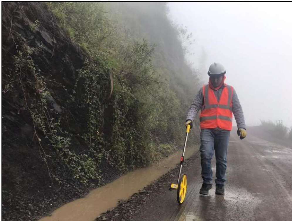
Figura 81 — Medicion de fallas de drenaje lateral inadecuado para el analisis con la metodologia URCI
