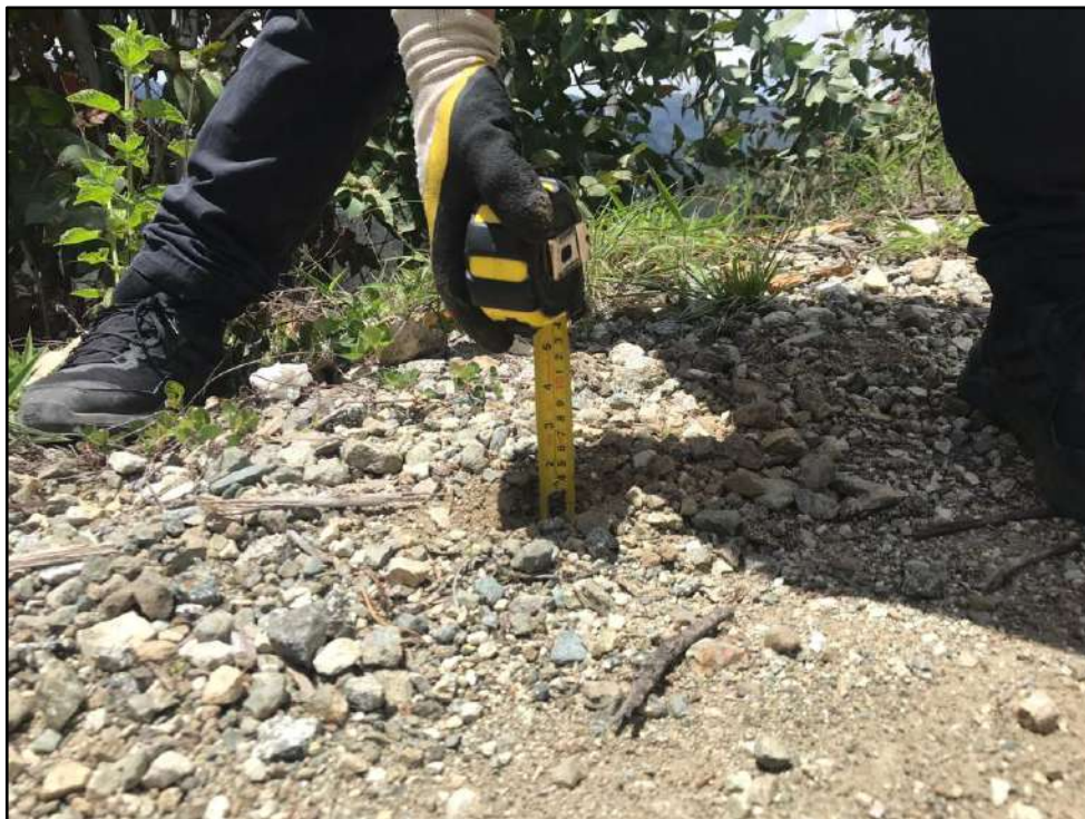
Figura 83 — Medicion de fallas de agregado suelto para el analisis con la metodologia URCI
