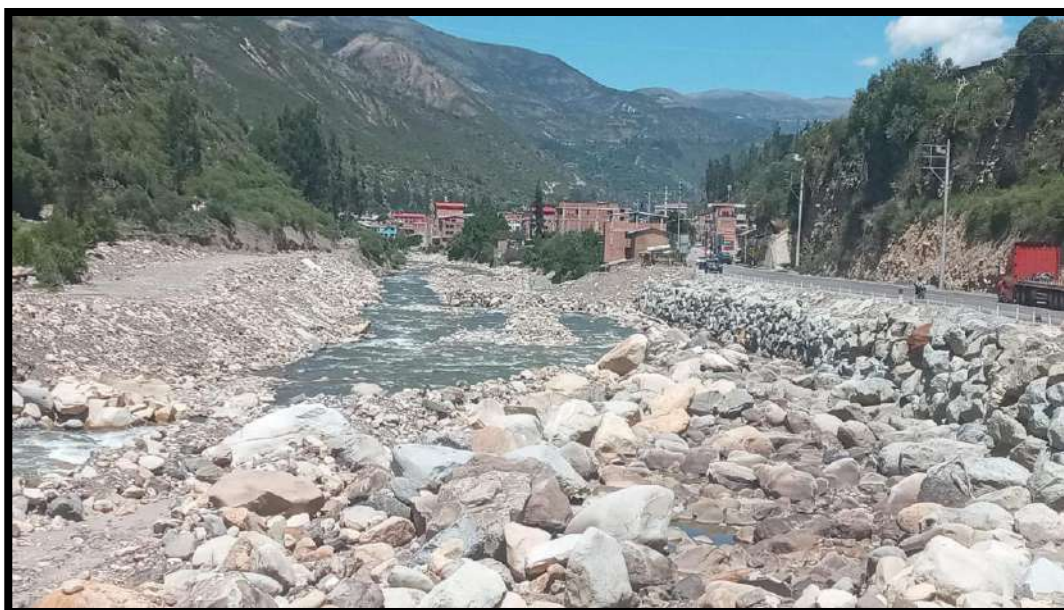
Figura 79 — Crecida y socavación del río progresiva Km 338+850.
