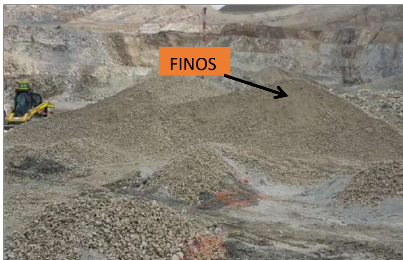
Fotografía 13: Material de stemming usado en el proyecto 3885-27, 28,29. Fuente: Asistencia técnica Orica - Las Bambas.
