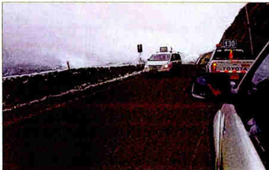
FOTOGRAFÍA 3-1. La falta de profundidad, perfil, pendiente y capacidad de drenaje ha ocasionado un exceso de agua sobre la vía.
