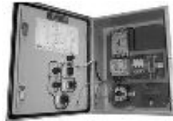
Figura 32: Tablero de encendido del winche eléctrico.
